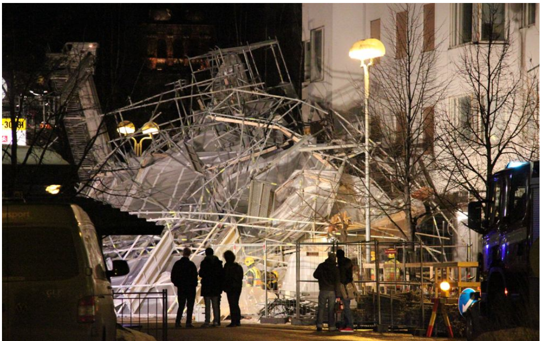
Kuva 1. Teline kaatumisen jälkeen. (kuva: Jarno Siira)
