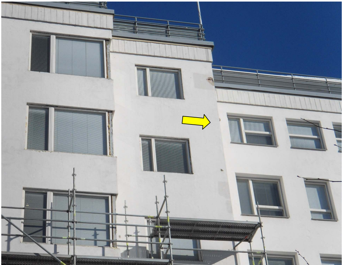
Kuva 3. Vaurion oletetun alkamiskohdan luota puuttui yksi ankkuri, jolloin ankkuriväli oli siinä kohdassa kaksinkertainen.
