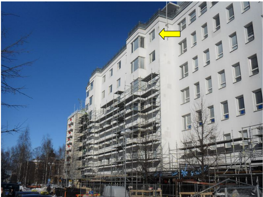
Kuva 4. Kaatuneen telineen tilalle rakennettava uusi teline. Onnettomuuspäivänä vallitseva tuulen suunta oli kuvan ottajan suunnasta. Telineiden irtoaminen seinästä alkoi nuolen luota.
