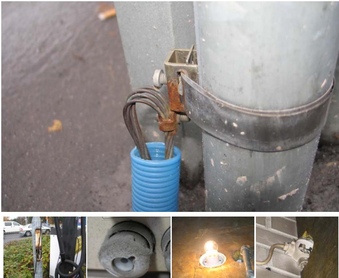
Kuva 3. Kaasunkeräyslinjan löysä maadoitusliitos ja esimerkkejä muista puutteista jakeluaseman sähköasennuksissa.
