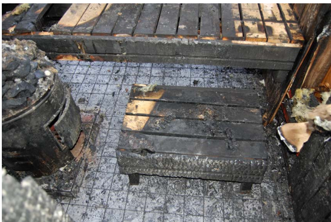
Kuva 8. Kuva saunatiloista, josta palo sai alkunsa.
