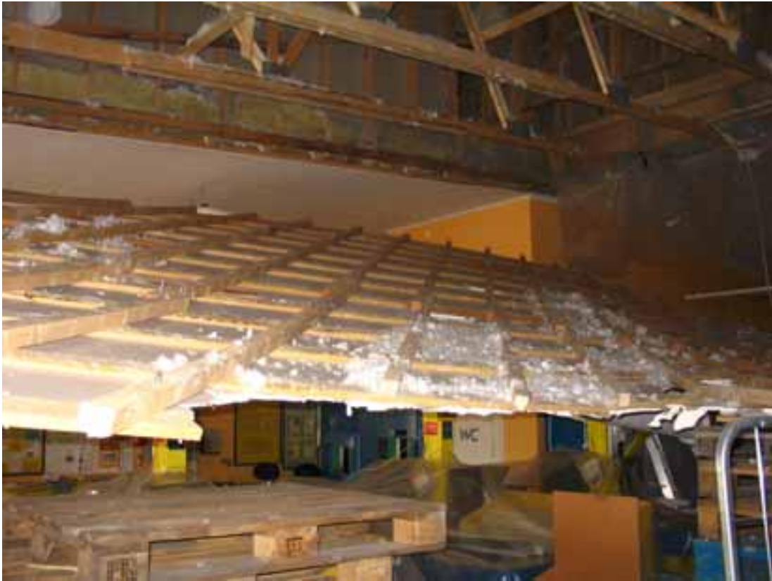
Kuva 7. Pudonnut sisäkatto yläpuolelta. Höyrysulku ja puhallusvilla on poistettu katon päältä.
