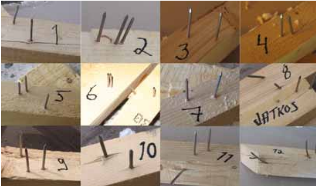
Kuva 8. Irronneita koolauksen naulaliitoksia.
