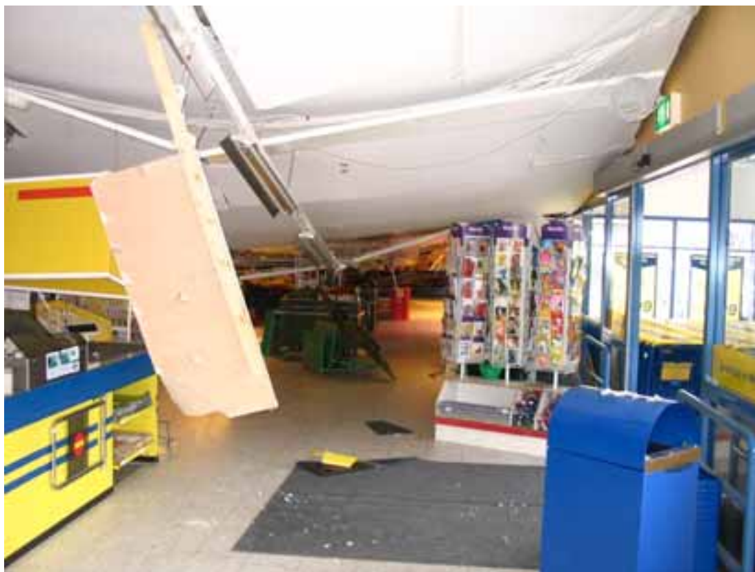
Kuva 3. Pudonnut sisäkatto katsottuna sisäänkäynnin luota. Keskellä kalusteita, joita kalusteasentaja oli asentamassa.
