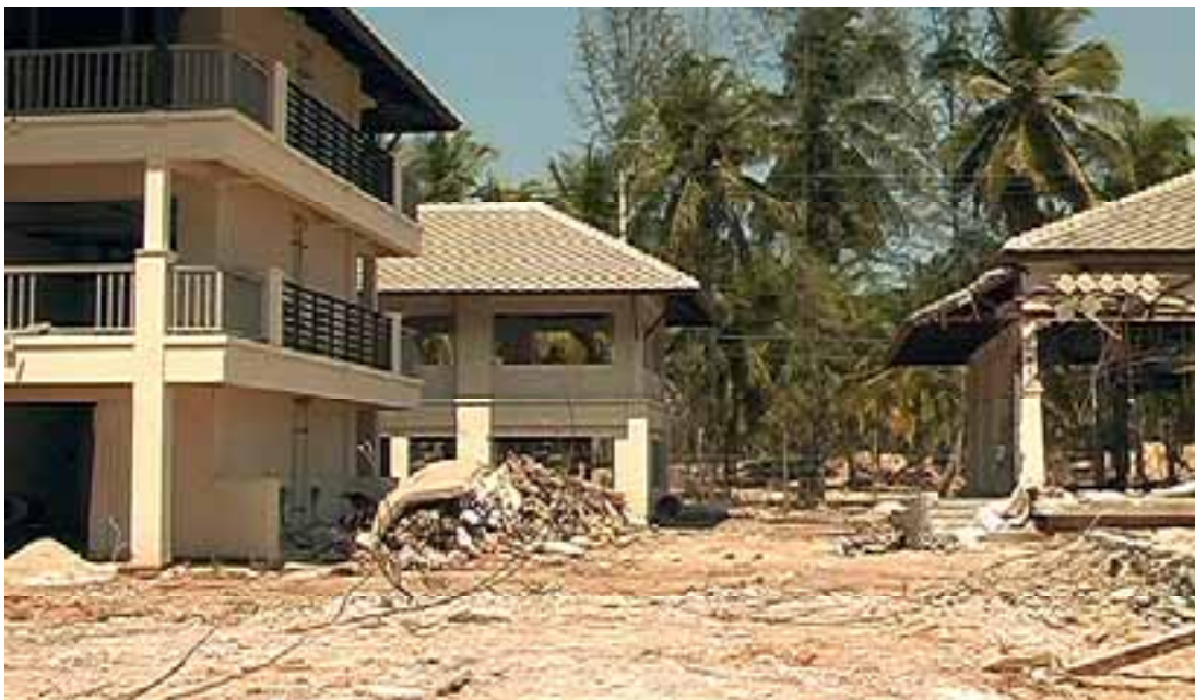
Kuva 17. Vankkarakenteiset talot pysyivät pystyssä, etenki jos niissä oli kevytrakenteisiä kantamattomia seiniä ja ikkunoita, jotka sortuivat veden paineesta. Kolmi-kerroksisten talojen ylimmät kerrokset säilyivät vahingoittumattomina.
