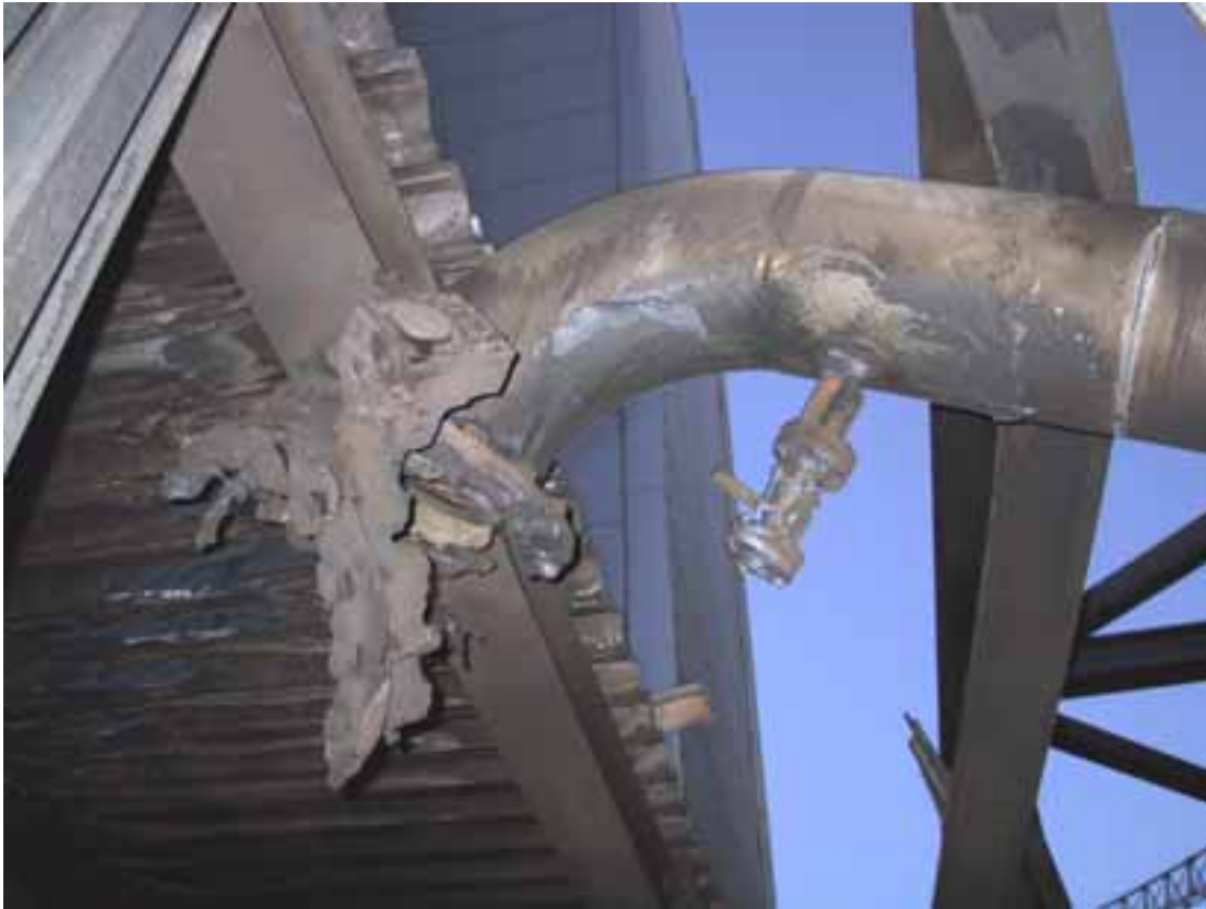
Kuva 6. Onnettomuusventtiilin yläpuolinen happiputki venttiilin jäänteineen taipui onnettomuudessa noin kolme metriä ylöspäin.
