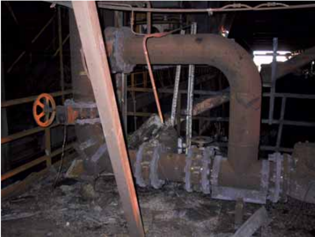
Kuva 11. Happilinja venttiilitasolla, noin 15 m venttiilihuoneen alapuolella. Vasemmalla on onnettomuusventtiilin kanssa samanlainen läppäventtiili VGO0410.
