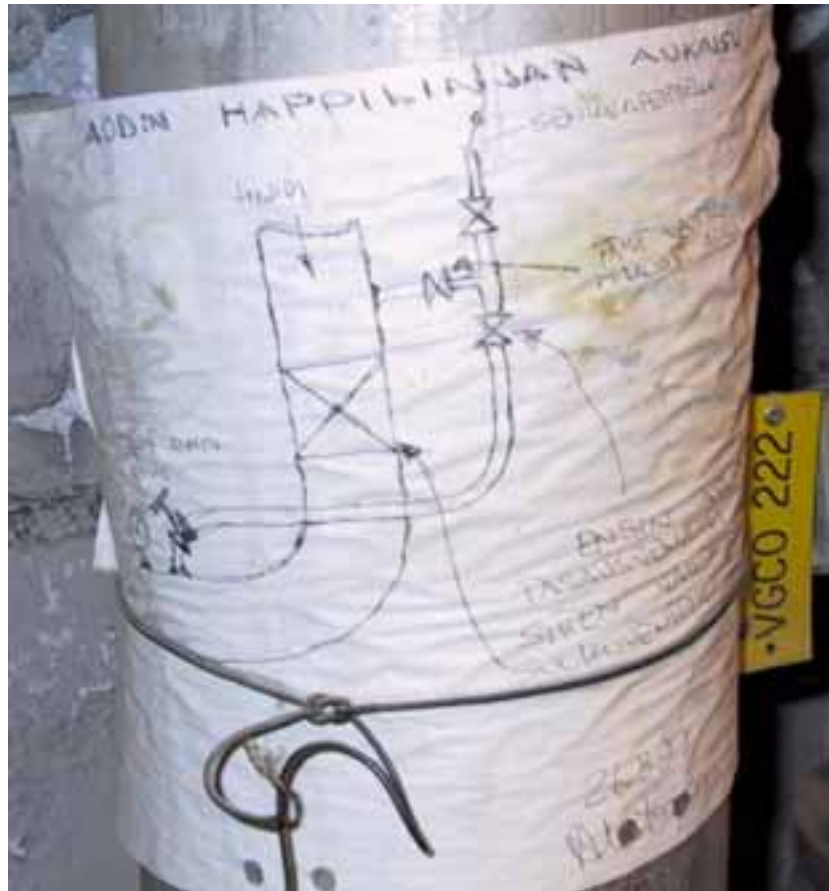
Kuva 18. Venttiilien avaamisesta kertova ohje happilinjassa sulatto 1:llä.
