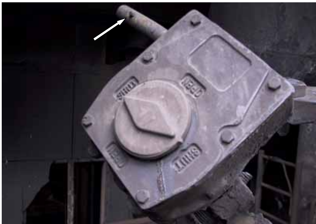
Kuva 8. Kuva venttiilin vaihteesta. Nuolen osoittamassa kohdassa käsipyörän sokan paikalla on katkennut ruuvi.
