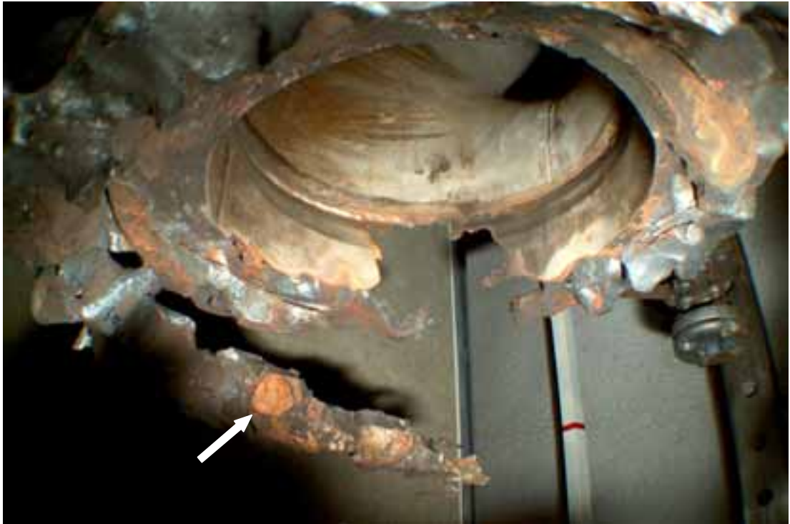
Kuva 16. Venttiilin runko paloi onnettomuudessa eniten läpän vapaan akselin läheltä. Edelleen rungon sisällä oleva vapaan akselin tynkä on osoitettu nuolella.
