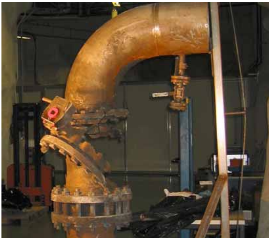
Kuva 14. Onnettomuuden jälkeen VTT:llä uudelleen koottu onnettomuusventtiili. Kuvassa näkyy ohituslinjan venttiili. Vaihteen keskellä näkyvästä keskiöstä on irtotettu muovinen osoitinkansi.
