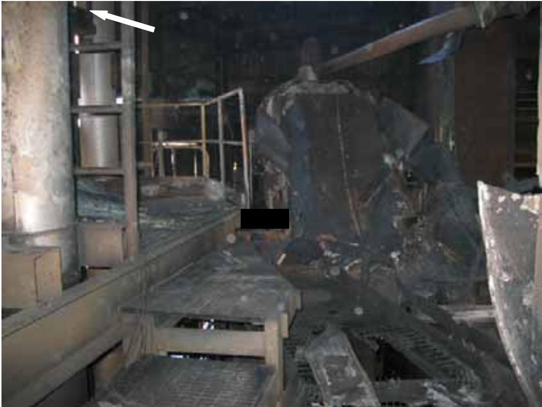
Kuva 4. Venttiilihuone tulipalon sammuttua. Työnjohtajat olivat avaamassa venttiileitä tasolla, joka on vasemmalta näkyvältä tasolta seuraava ylöspäin. (Kuva: Tornion poliisi)
