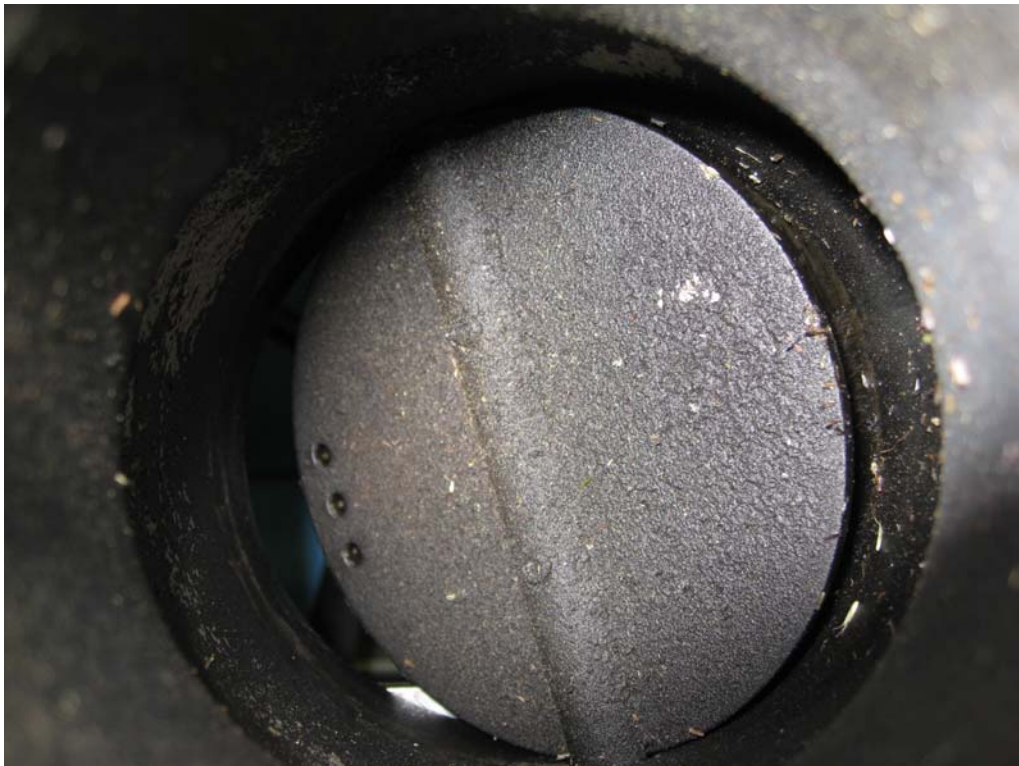
Kuva 6. Polttoainesäätimen likainen ilmaläppä ja ilmakanava
