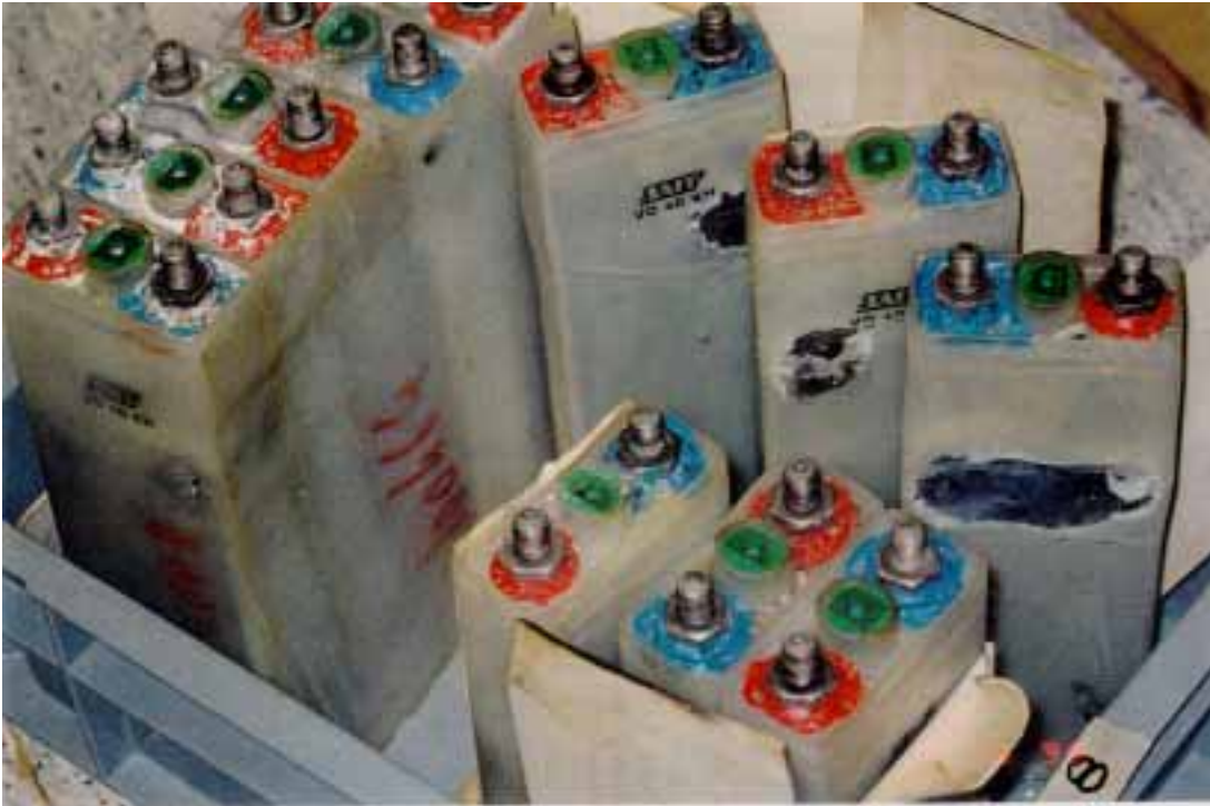
Kuva 2. Akun 1 kennoja. Kennojen virtanapojen juuressa olevat punaiset (+) ja siniset (-) muovirenkaat olivat sulaneet kennojen yläpinnalle. Myös kennoissa oli sulamisjälkiä.
