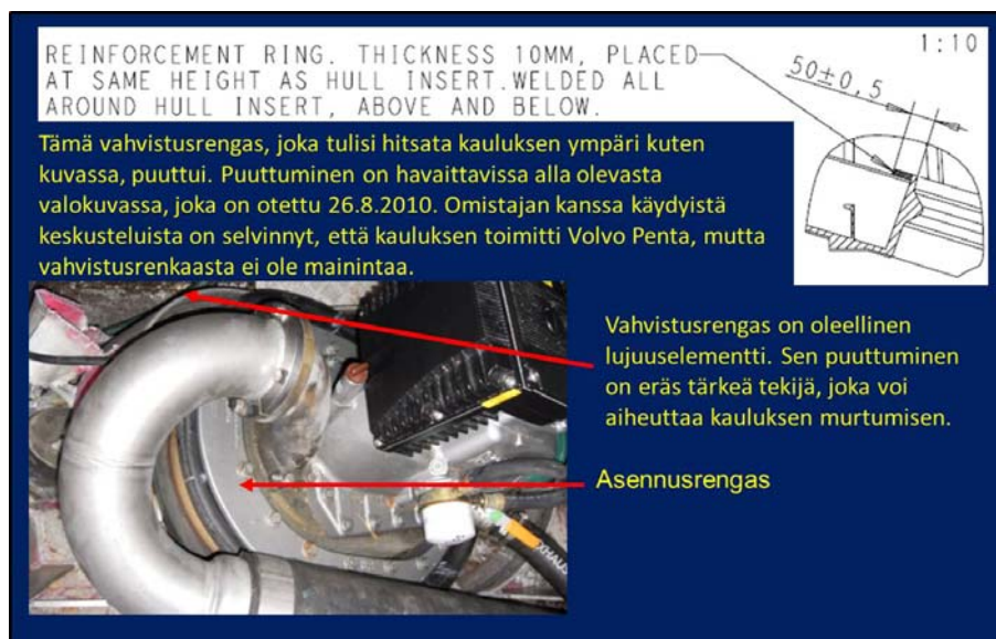
Kuva 2a. Vahvistusrenkas puuttui IDA 1:n asennuksesta.
