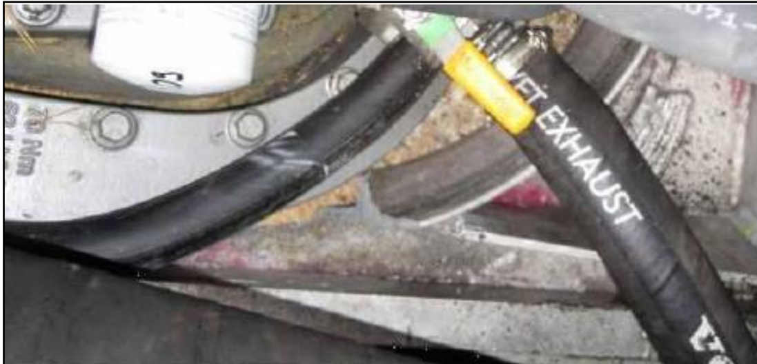
Kuva 3b. Murtunut asennuskaulus kuvattuna elokuussa 2010.
