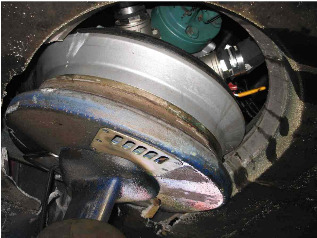
Kuva 16b. Oikean puolen vetolaitteen läpivienti. Aukko pohjassa. O-renkaat ovat pois paikoiltaan, ks. liitteen kuva 5.
