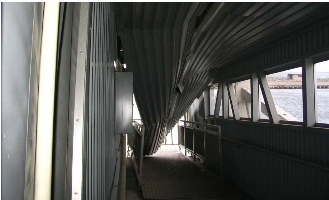
Kuva 17. Maihinnoususillan pudonnut katto.
