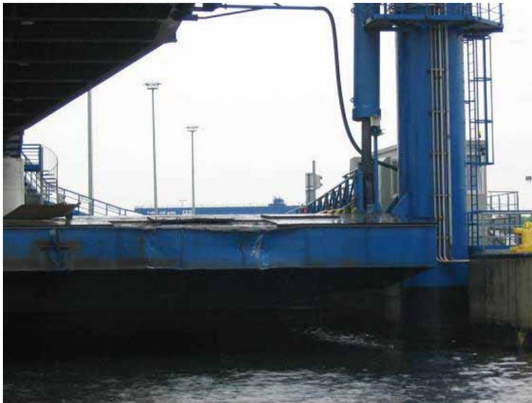
Kuva 20. Vauriot laiturin rampissa.
