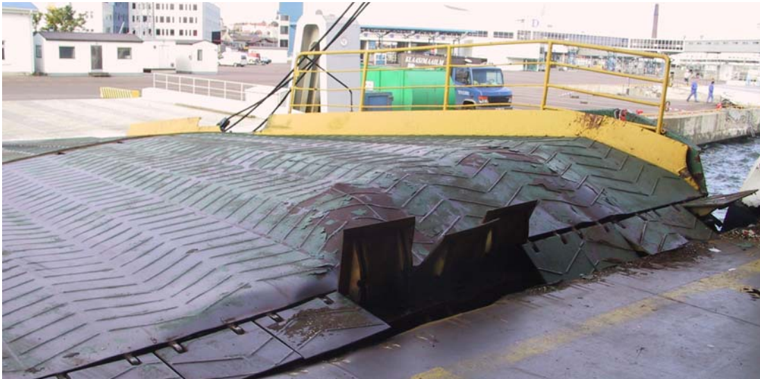
Kuva 18. MS TRANSLANDIAN vaurioitunut peräramppi.
