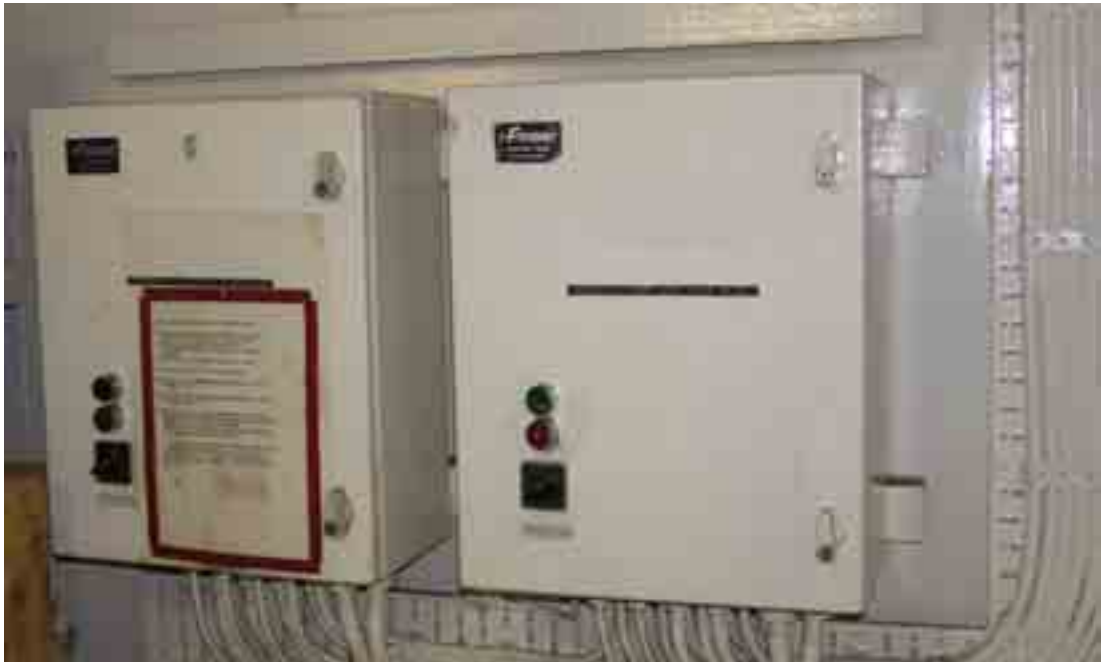
Kuva 3. Peräsimen hydraulikkapumppujen kytkentäkaapit. Vasemman puoleisessa kaapissa hätäohjauksen ohjeistus.
