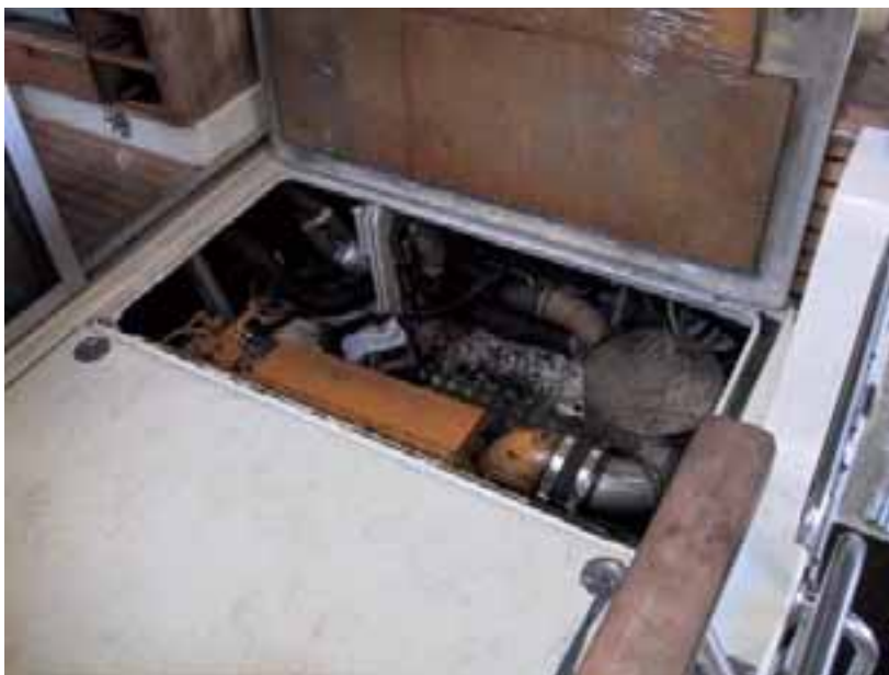
Kuva 4. Sun 33 -veneen konetilan luukku oikea luukun puolisko avattuna. Kuva on otettu veneen pelastamisen jälkeen ennen korjausta. Luukussa ei ollut tiivistettä eikä kiristimiä, joilla se olisi ollut vesitiivis. Karveli (luukun aukon reunus) puuttui keskilinjalla ja vasemman luukun reuna toimi karvelina oikealle luukulle. Risteyskohdissa oli tällainen rakenne erityisen epätiivis.
