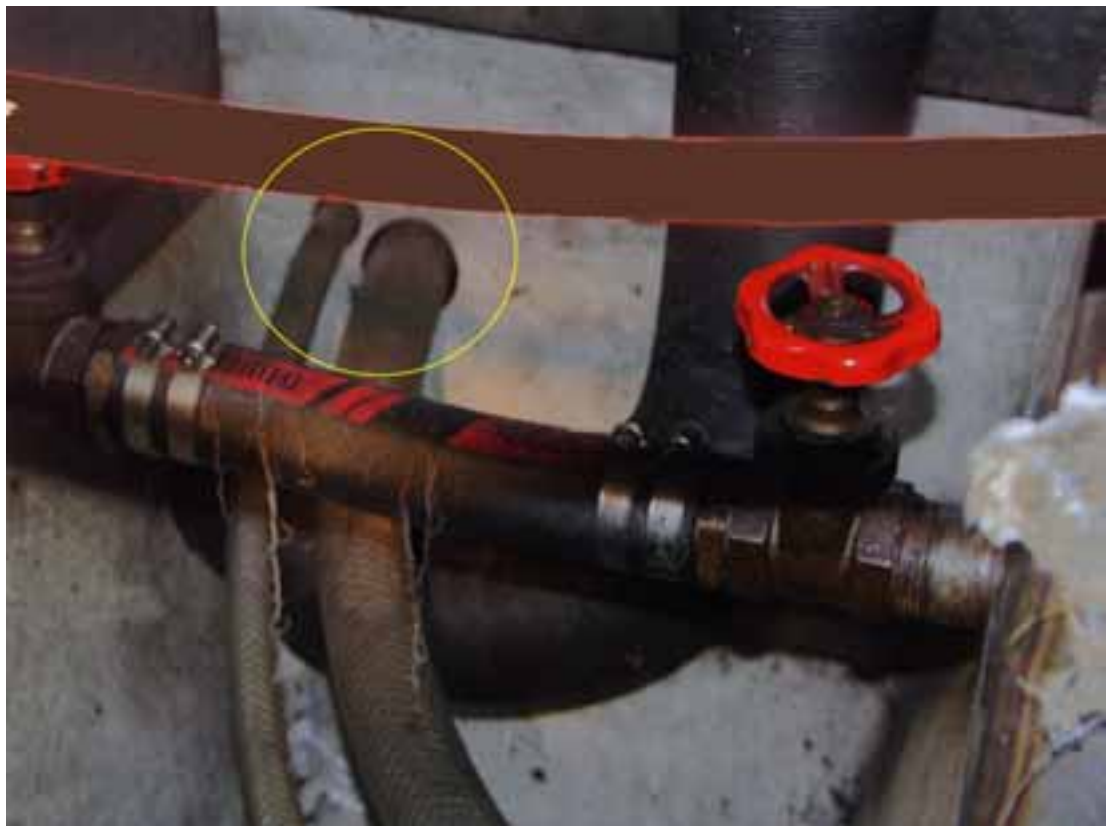
Kuva 12. Konetilan laipion läpi kulkevia vesiletkuja. Letkuja varten oli laipion alaosaan porattu reiät eikä laipio enää asennuksen jälkeen ollut tiivis.
