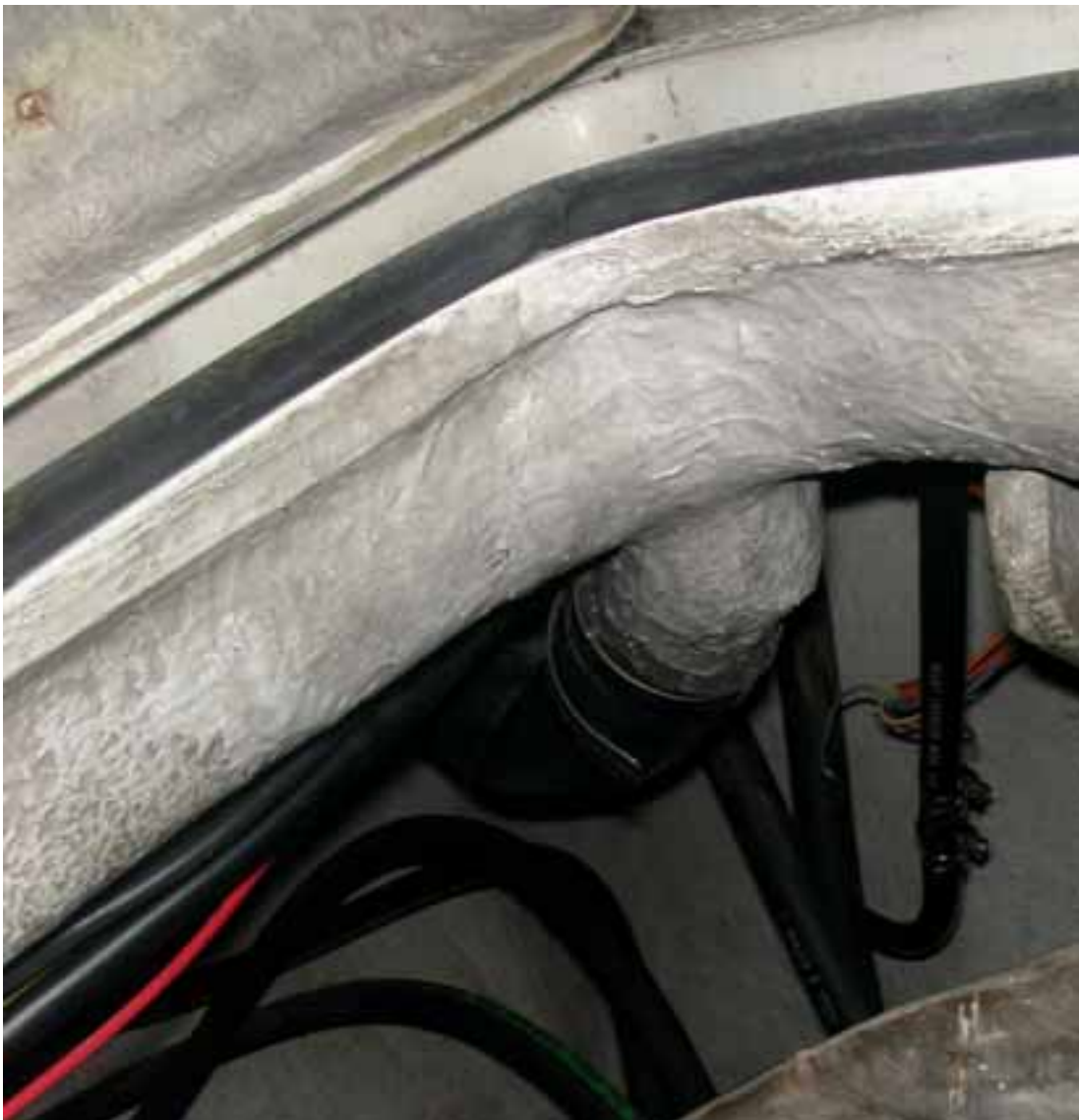
Kuva 2. Vesikourun peränurkka. Kuvassa näkyy sadeveden tyhjennysputken liittyminen kourun nurkkaan sekä luukussa olevan tiivisteen vastapinnan epä-määräinen ja epätarkka muoto. Kuva on otettu korjauksen jälkeen. Korjaukseen liittyen oli luukun aukkoon asennettu kuvassa näkyvä musta tiiviste-nauha.
