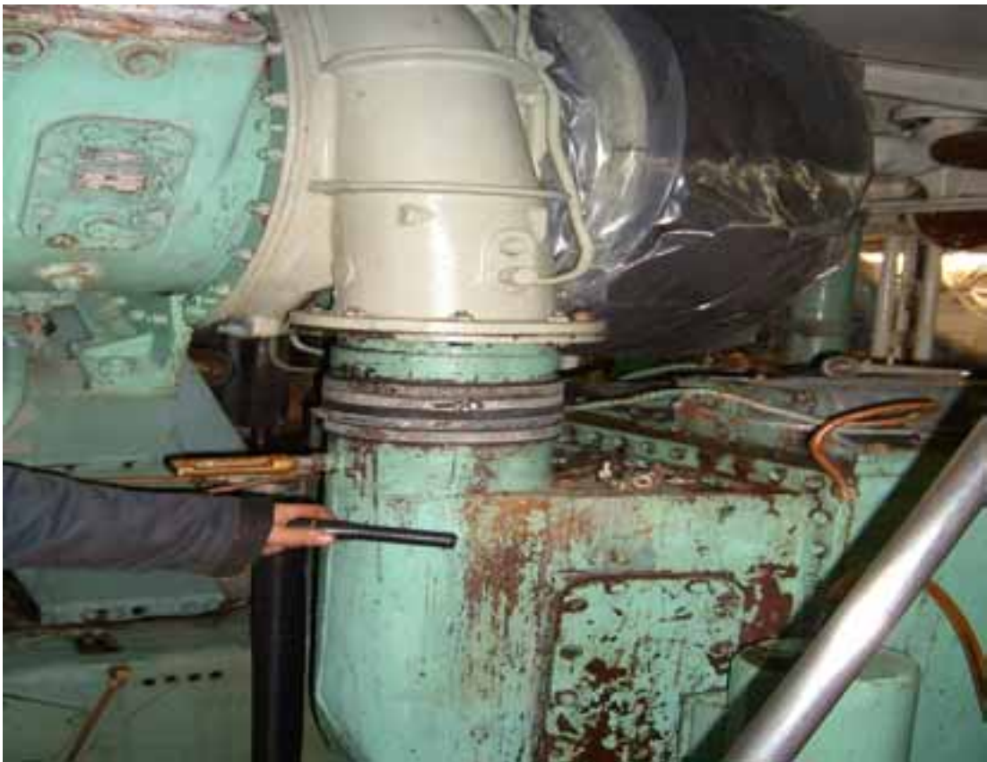
Kuva 7. Karilleajossa syntyneiden vuotojen seurauksena konehuoneessa vesi nousi kuvassa osoitetulle kohdalle.
