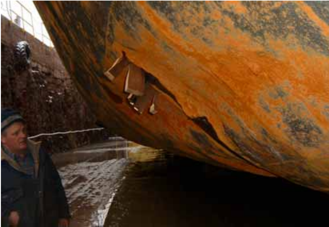
Kuva 6. Repeämä konehuoneen kohdalla.
