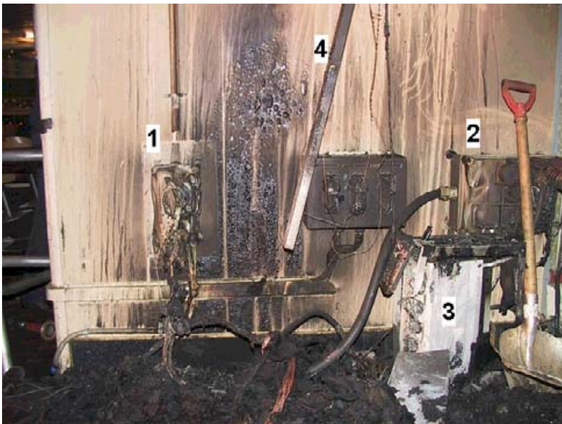
Kuva 2. Palaneen estradiverhon takainen seinä laitteineen. 1.) kolmivaihepistorasia, 2.) pistorasiakeskus, 3.) valohimmennin, ns. "valourku", 4.) esiripun alumiininen verhotanko taittuneena alaspäin.
