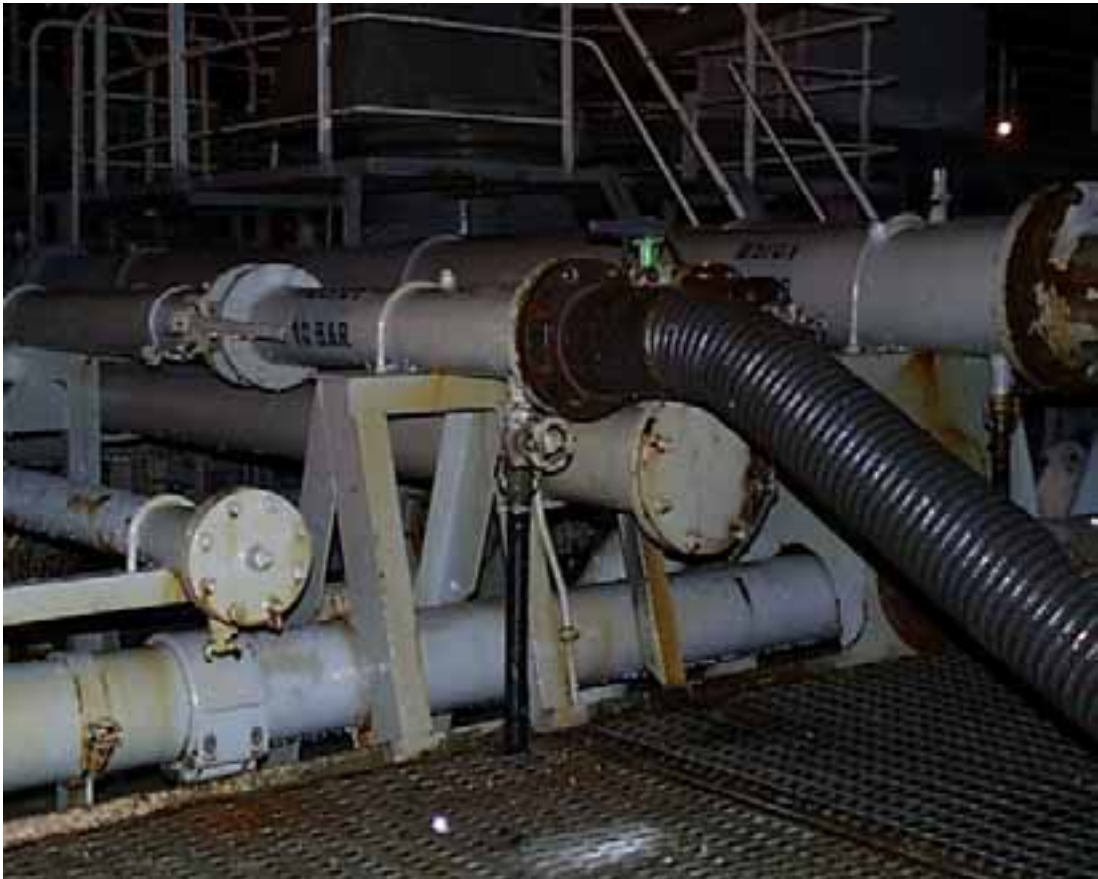
Kuva 4. Kuvan keskellä auki ollut venttiili lastiputken alla. Mustaa suoraan alaspäin johtavaa letkua pitkin bensiiniä vuoti ritilän alla olevaan valuma-altaaseen.
