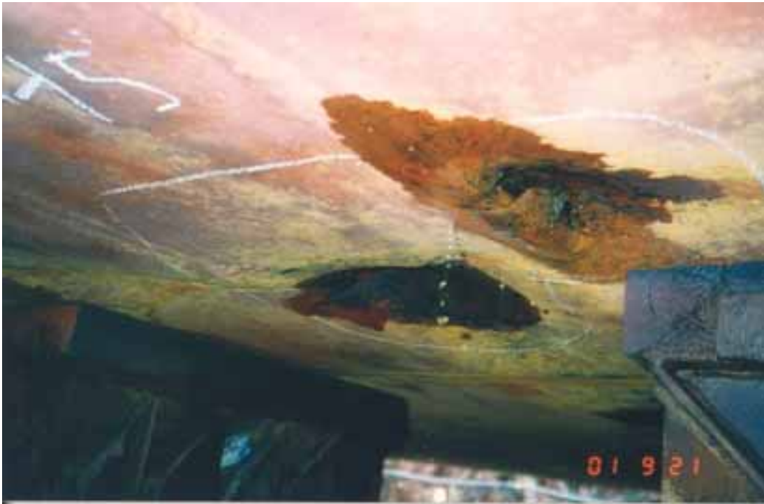
Kuva 9. CINDYn pohjavaurioita kuvattuna telakalla Maarianhaminassa.
