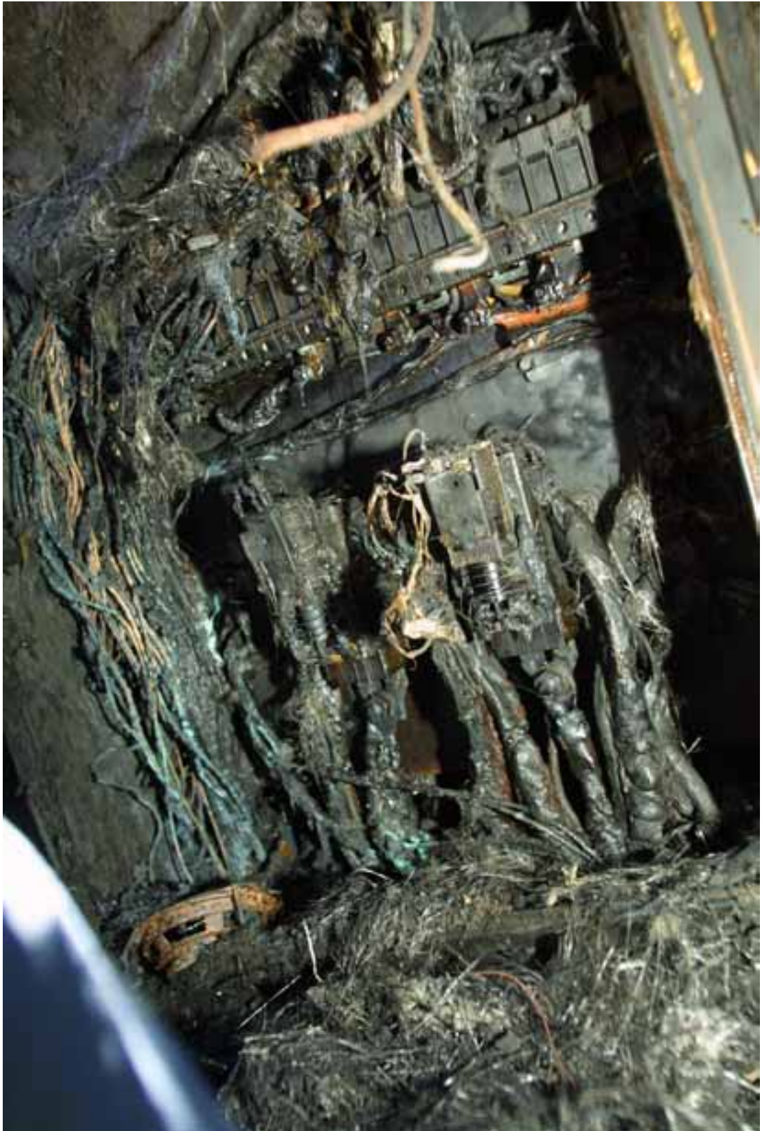
Kuva 2. Sähköpääkeskus kuvattuna ennen irrotusta.
