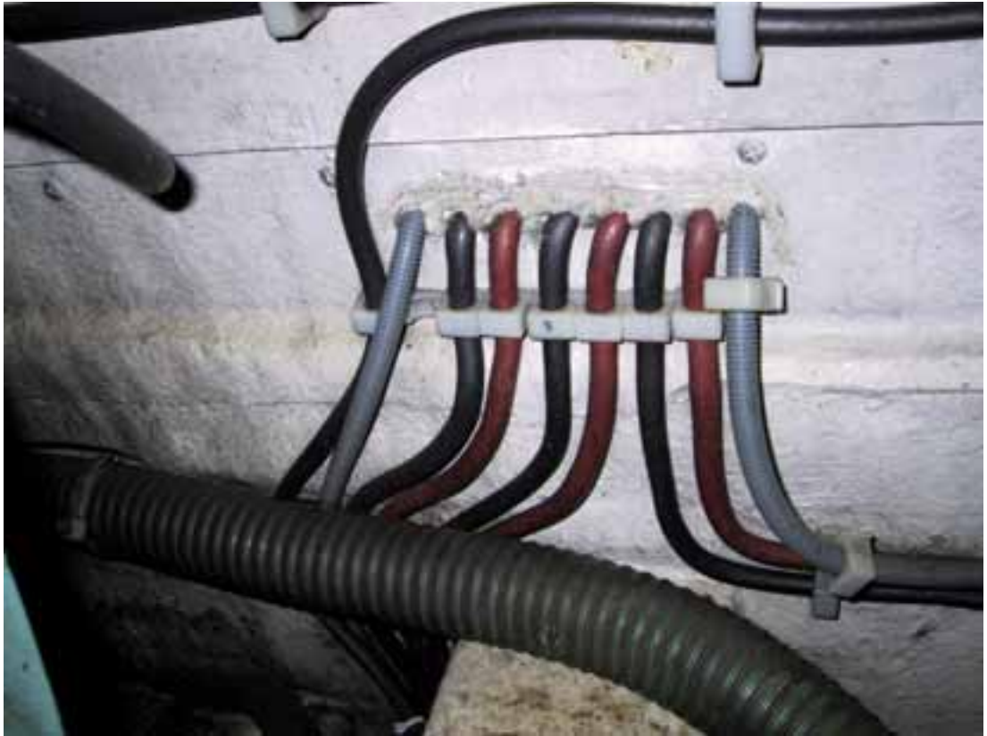
Kuva 7. Akkukaapelit kuvattuna konehuoneen puolelta. Yksi kiinnitin on rikki ja yksi irronnut seinästä. Läpivientiaukko on tiivistetty.
