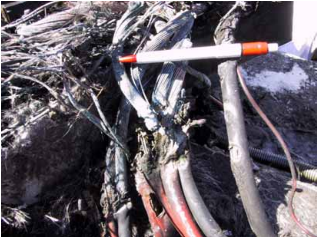
Kuva 8. Akkukaapelit kuvattuna sähköpääkeskuksen irrotuksen jälkeen. Kynä osoittaa kaapelin molemmista päistään irti palanutta osaa.
