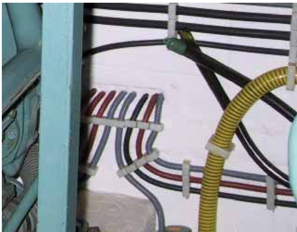
Kuva 5. Akkukaapelit kuvattuna ensimmäisen vertailuna käytetyn Princess 55 -aluksen konehuoneesta.
