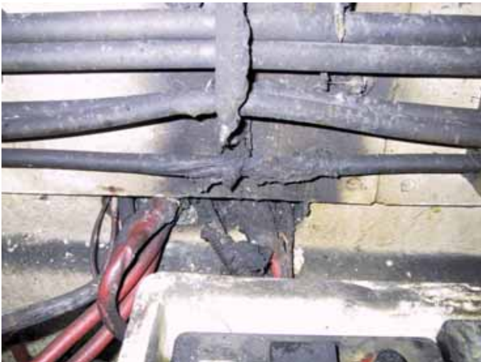
Kuva 4. Näkymä LINDA MARIAN konehuoneen puolelta. Kaapeleita ei ollut tuettu millään tavalla ja ne kulkivat osittain päällekkäin.
