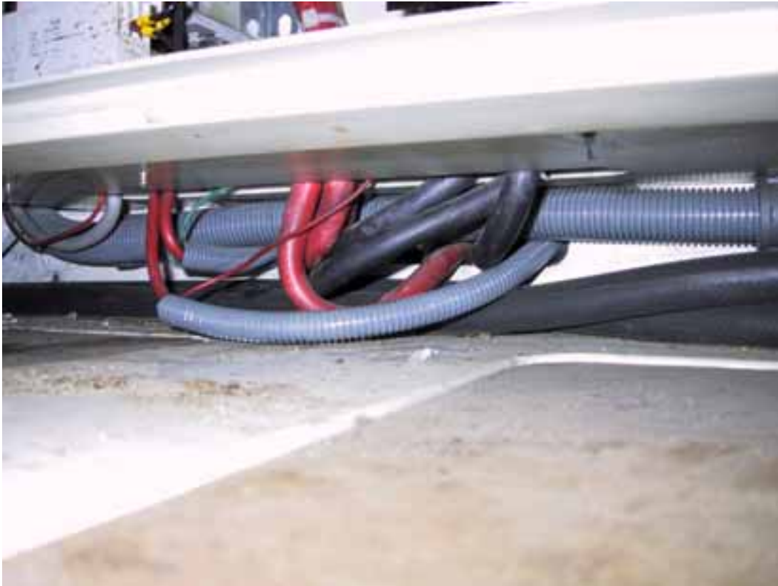
Kuva 6. Akkukaapelit sähköpääkeskuksen alla (toisesta vertailualuksesta).
