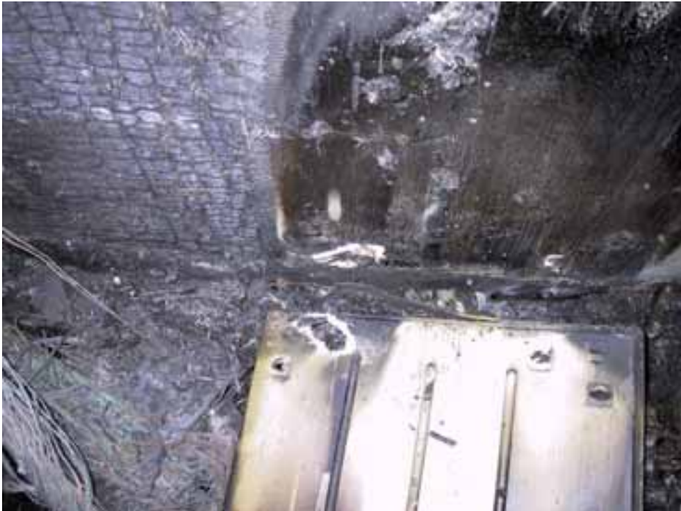
Kuva 3. Sähköpääkeskuksen takaseinä on irrotettu paikaltaan ja käännetty lattialle. Vasemmassa alareunassa näkyy pahoin hiiltynyt vaneriseinä. Nuoli osoittaa kaapeleita ja läpivientiaukkoa seinässä.
