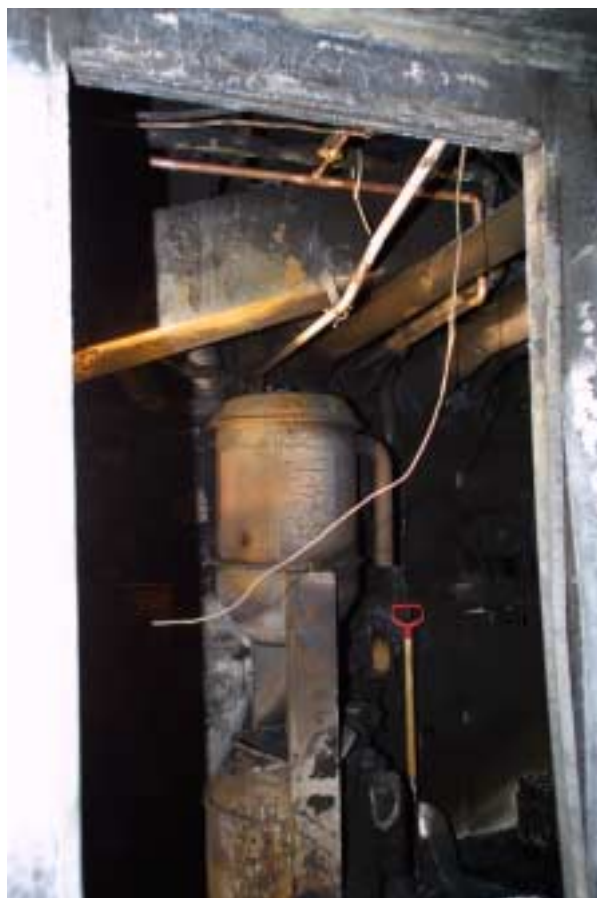
Kuva 6. Keskuspölynimurihuone, jonka katosta polttoleikkausliekki tuli läpi.
