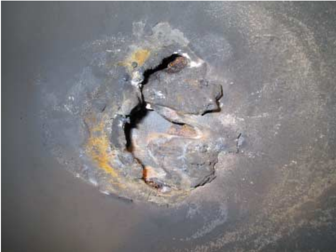
Kuva 7. Lähikuva polttoleikkausliekin jäljestä keskuspölynimurihuoneen katossa.
