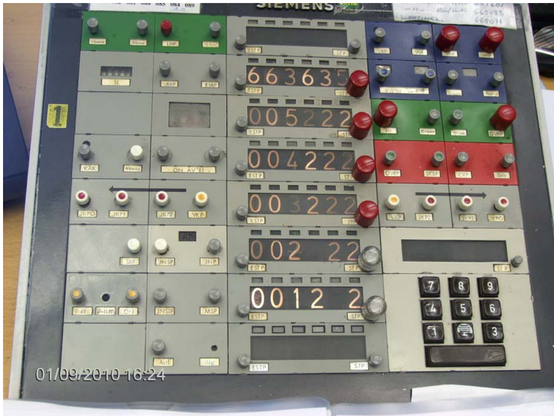
Kuva 12. Asetinlaitteen ohjauslaite. Laitteella tehdään komennot asetinlaitteelle käyttäen numeronäppäimiä ja painikkeita.
