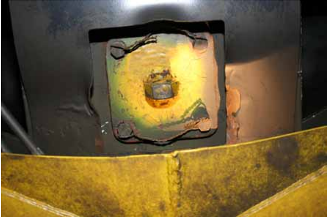
Kuva 5. Kuva vetolaitteen kotelosta alhaalta päin. Pidätinlevyn ruuveissa on teräslankavarmistus.
