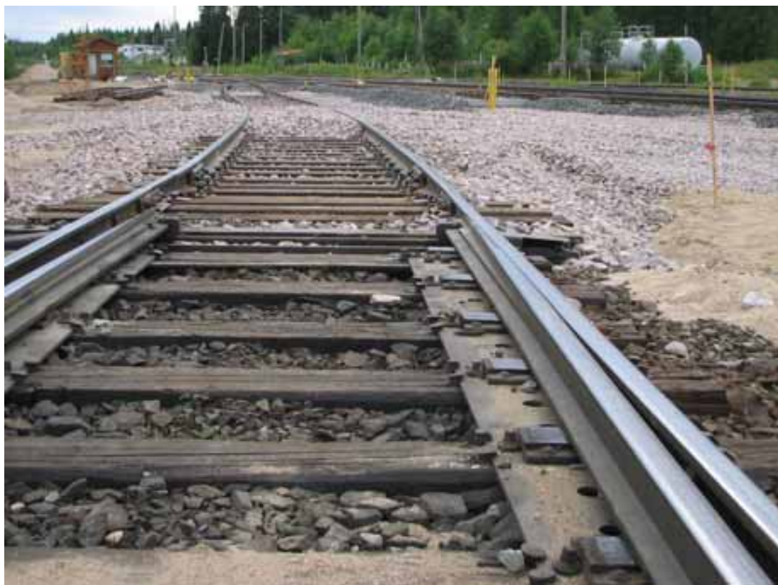
Kuva 5. S-kaarre katsottuna junan kulkusuuntaa vasten. Etualalla vaihde V054 jossa vaunut suistuivat.
