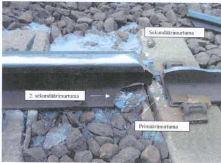
Kuva 3. Yksityiskohtaisempi kuva vauriokohdasta.
