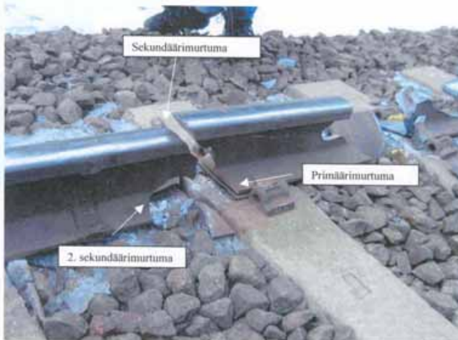
Kuva 4. Yksityiskohtaisempi kuva vauriokohdasta.
