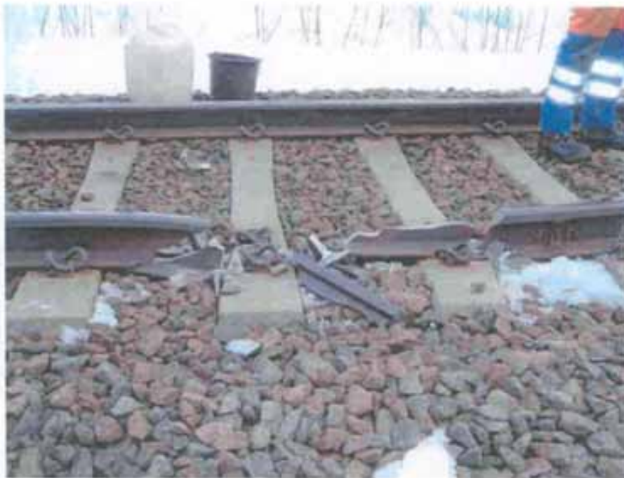
Kuva 1. Yleiskuva onnettomuuspaikalta. Junan kulkusuunta oikealta vasemmalle.
