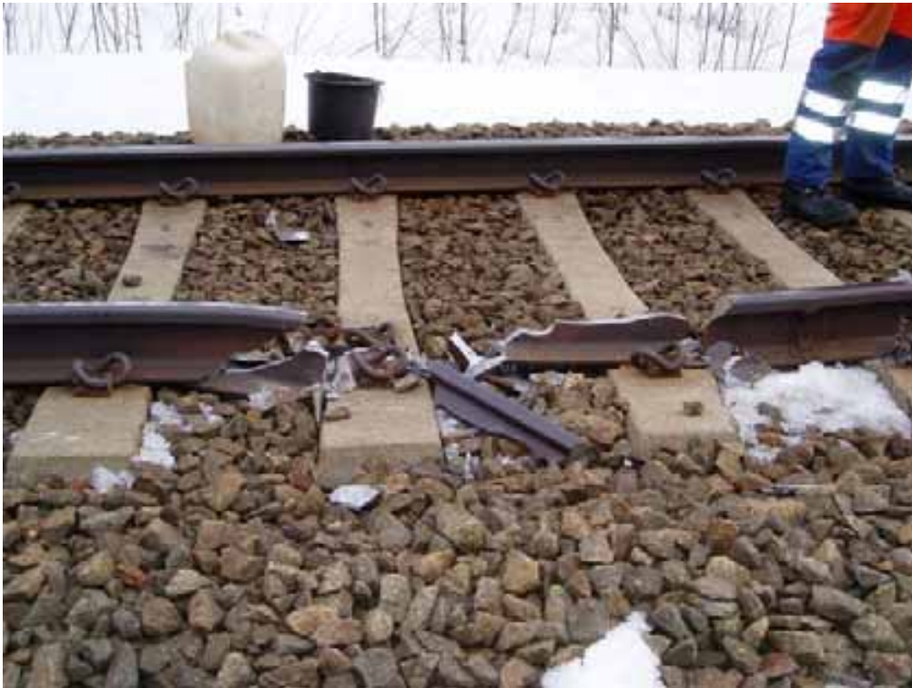
Kuva 5. Kisko oli murtunut noin metrin matkalta. Junan kulkusuunta on kuvassa oikealta vasemmalle.
