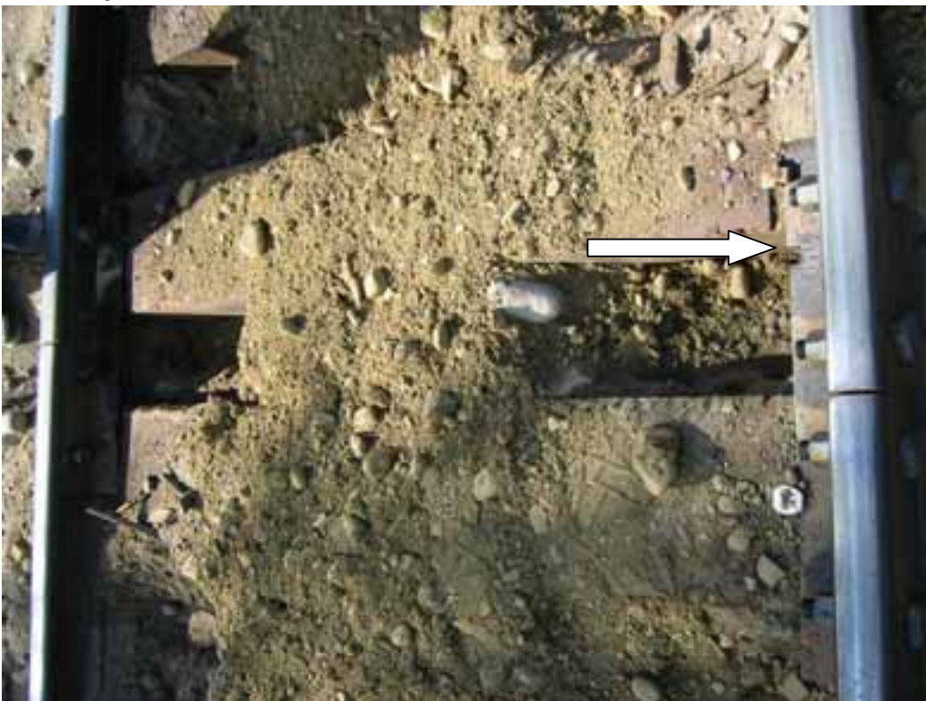
Kuva 4. Yhdeksän puutavaralastissa olleen tavaravaunun suistuminen Rantasalmella 31.7.2003. Kuvassa näkyy jatkoskohtien kohdistamattomuus ja nuolen osoittama aluslevyn siirtyminen kiinnityksestään.
