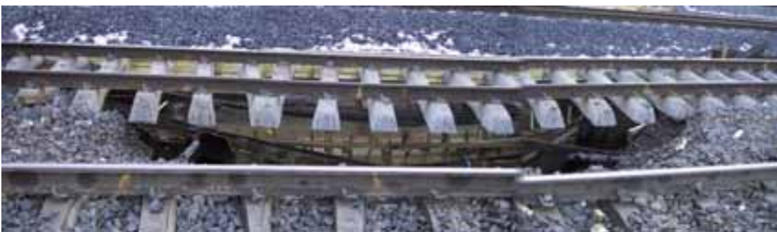
Kuva 6. Ratapenkereen sortuma Urpian alikulkutyömaalla Vantaalla 20.12.2003. Kuva on koottu kolmesta erillisestä kuvasta, josta johtuu epäjatkuvuuskohtat kummallakin puolella keskikohtaa.
