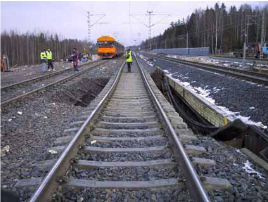
Kuva 5. Ratapenkereen sortuma Urpian alikulkutyömaalla Vantaalla 20.12.2003. Kuva otettu Pendolino-junan tulosuunnasta. Vasemmalla näkyvää läntistä raidetta kulkevat junat ajettiin Sn 5 km/h-nopeudella valvottuna.
