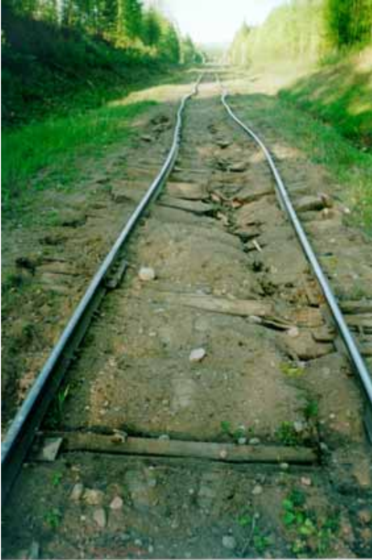
Kuva 4. Kolmen puutavaravaunun suistuminen kiskoilta Huutokoskella 31.5.2002. Viimeisen vaunun vasemmanpuoleiset pyörät rikkoivat pölkytystä.
