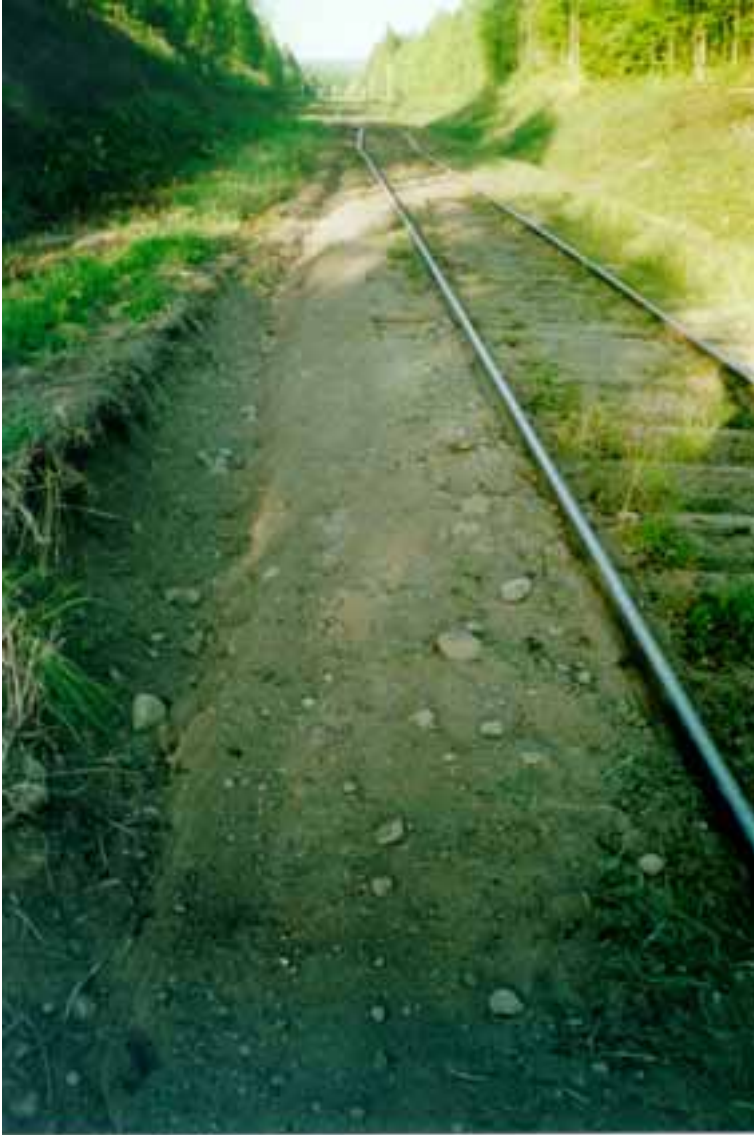
Kuva 5. Kolmen puutavaravaunun suistuminen kiskoilta Huutokoskella 31.5.2002. Viimeisen vaunun oikeanpuoleiset pyörät painuivat lopulta syväälle ratapenkereeseen.
