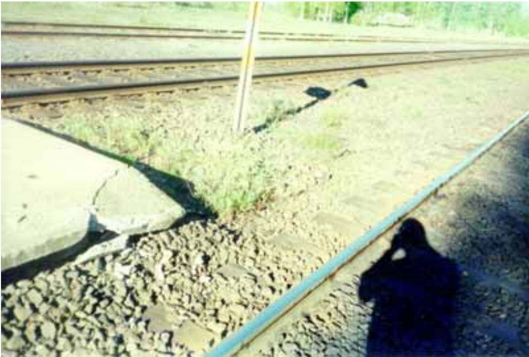
Kuva 6. Tavaravaunun laakerivaurio ja suistuminen Muhoksella 27.5.2002. Muhoksen aseman välilaiturissa oleva tuore murtuma kuvattuna 28.5. aamulla.
