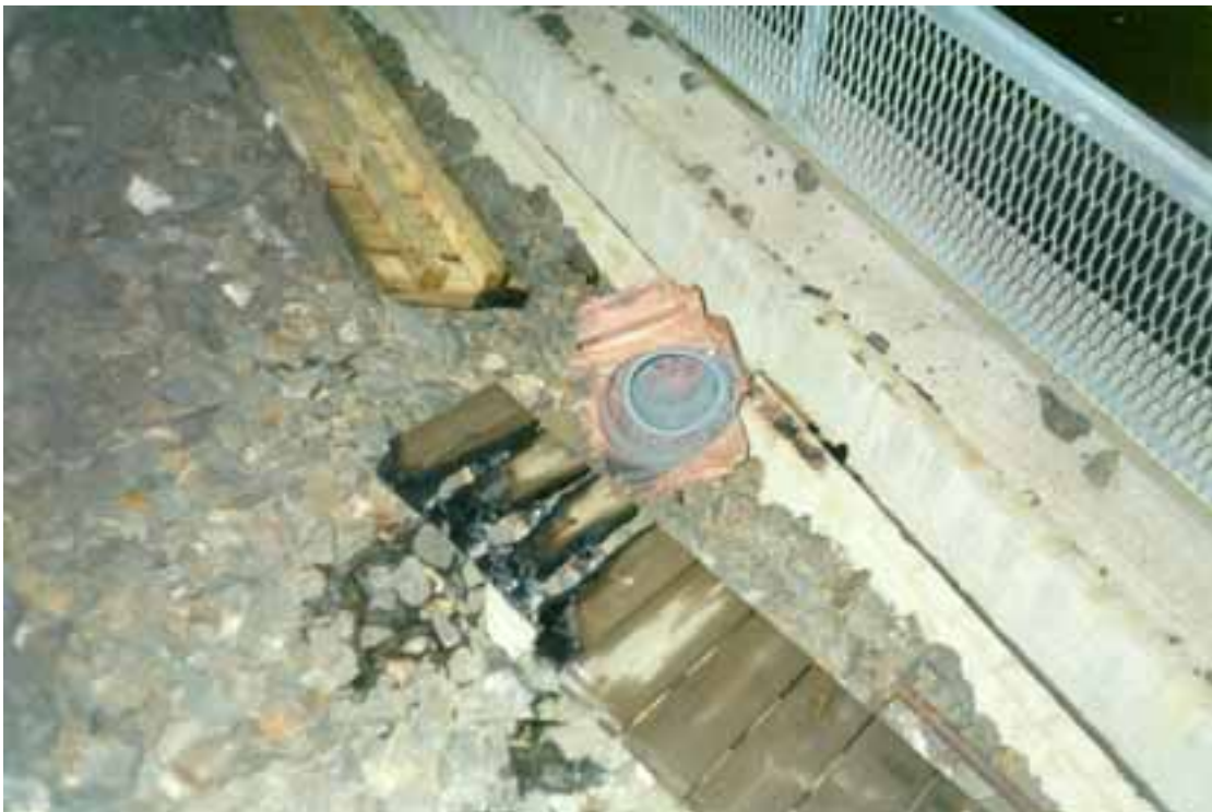
Kuva 3. Tavaravaunun laakerivaurio ja suistuminen Muhoksella 27.5.2002. Kuuma laakeripesä syytti tulipalon Tikkalantien sillan kaapelikourun suojakannessa
