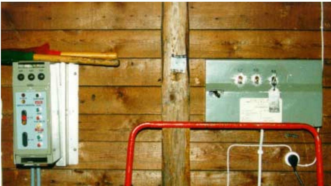
Kuva 5. Kolmen tavaravaunun suistuminen kiskoilta Rauhassa 26.1.2001. Vaihteen V1 luona olevassa vaihdekojussa olevat ohjaustaulu ja kosketinlaite.
