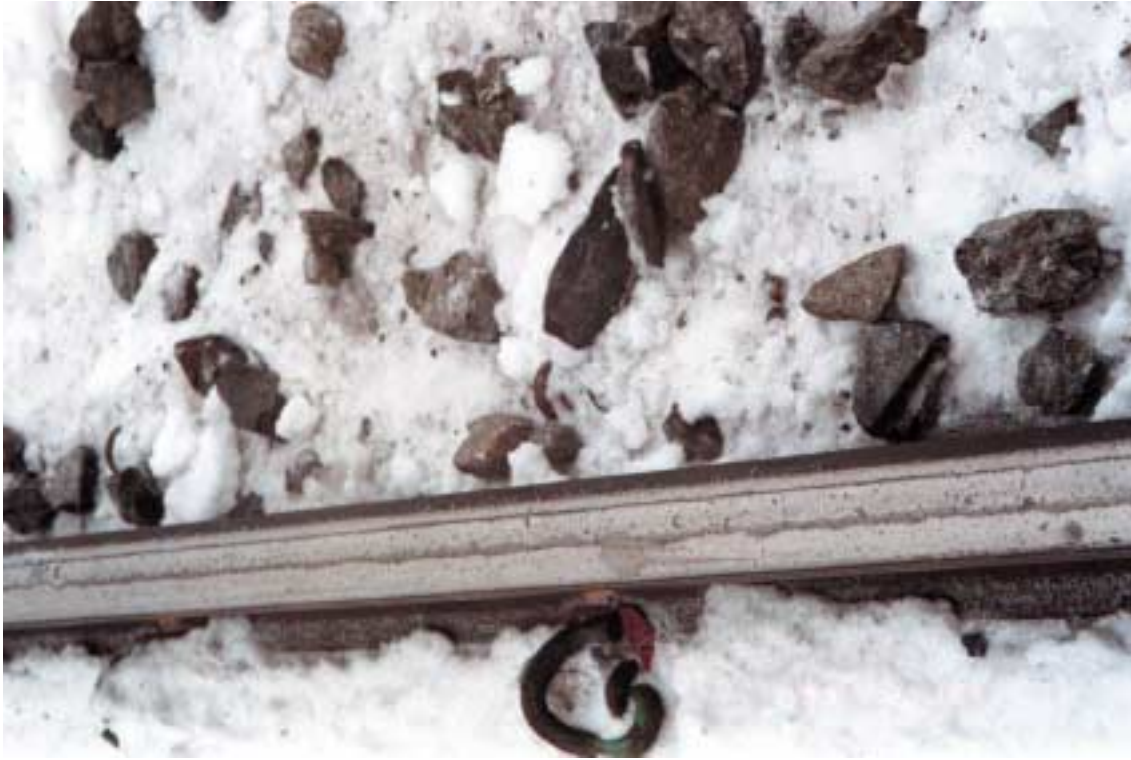
Kuva 4. Tavarajunan suistuminen kiskoilta Jalasjärvellä 19.2.1999. Paikka, jossa vaunun oikea takapyörä ylitti kiskon ja putosi kiskon vierelle. Kiskon kiinnitysrousia irtosi noin 9 km:n matkalta.
