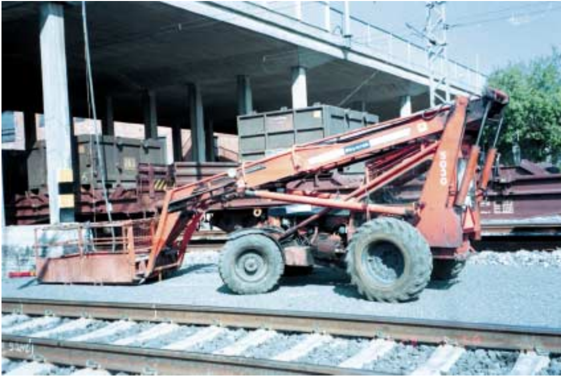
Kuva 2. Vaaratilanne sillanmaalauustyömaalla Hämeenlinnassa 28.8.1997. Kurottaja. Figure 2. Hazardous situation on bridge painting site in Hämeenlinna, on August 28, 1997. The reach truck.
