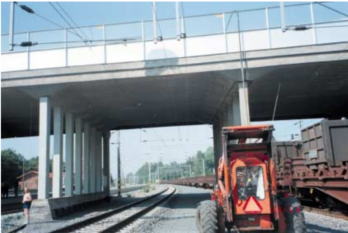
Kuva 3. Vaaratilanne sillanmaalauustyömaalla Hämeenlinnassa 28.8.1997. Raide, jonka yläpuolella hiekkapuhaltaja oli työssä. Veturin keula oli toisena näkyvän sähköratapylvään kohdalla kurottajan kuljetajan havaitessa sen. Figure 3. Hazardous situation on bridge painting site in Hämeenlinna, on August 28, 1997. The track on which the sandblaster was working. The front of the engine was located behind the second electric track pole when the driver of the reach truck noticed it.
