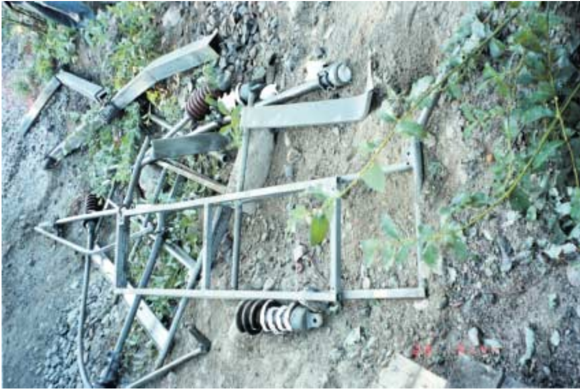
Kuva 5. Johdonvetojunan törmäminen sähkörataportaaliin Hämeenlinnassa 27.8.1997. Rikkoutuneen ripustusorren osia sekä rikkoutunut johdonvetojunan kaide.
