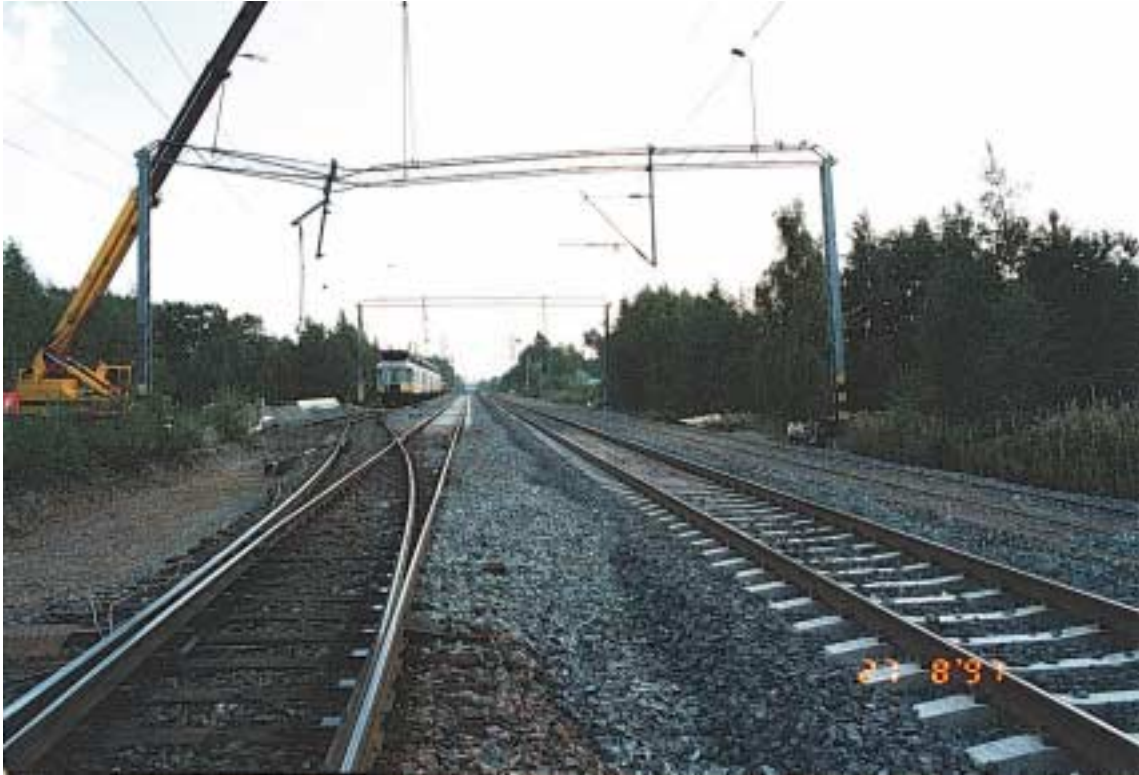
Kuva 3. Johdonvetojunan törmäminen sähkörataportaaliin Hämeenlinnassa 27.8.1997. Vioittunut portaali ja portaaliin osunut johdonvetojuna.
