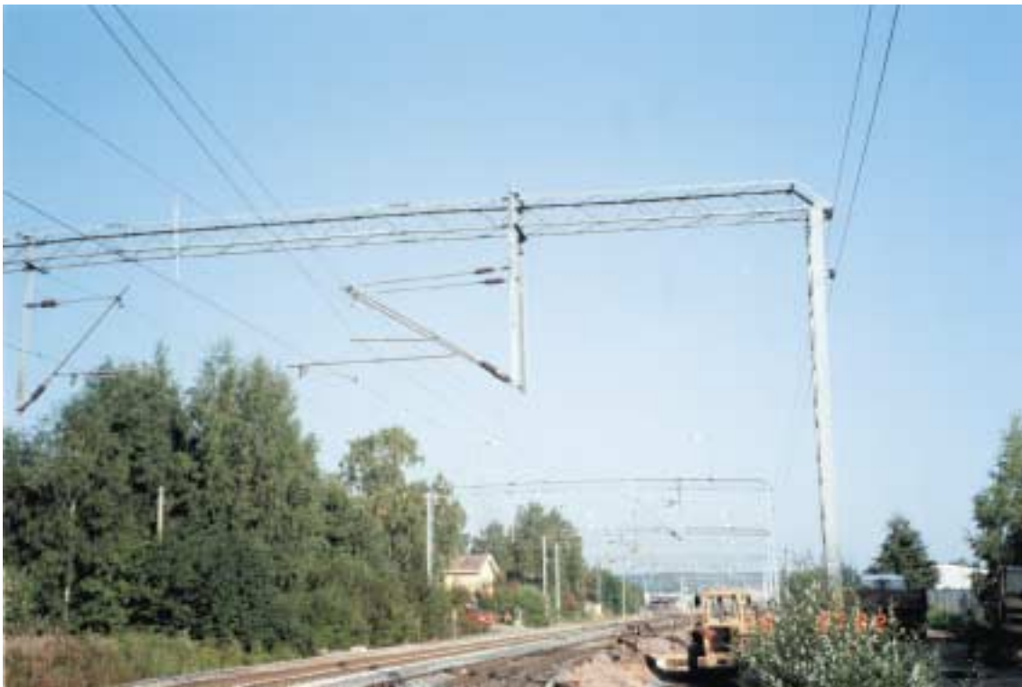
Kuva 4. Johdonvetojunan törmäminen sähkörataportaaliin Hämeenlinnassa 27.8.1997. Rikkoutuneena olleet portaaliorsi ja ripustusorsi osineen korjattuna.
