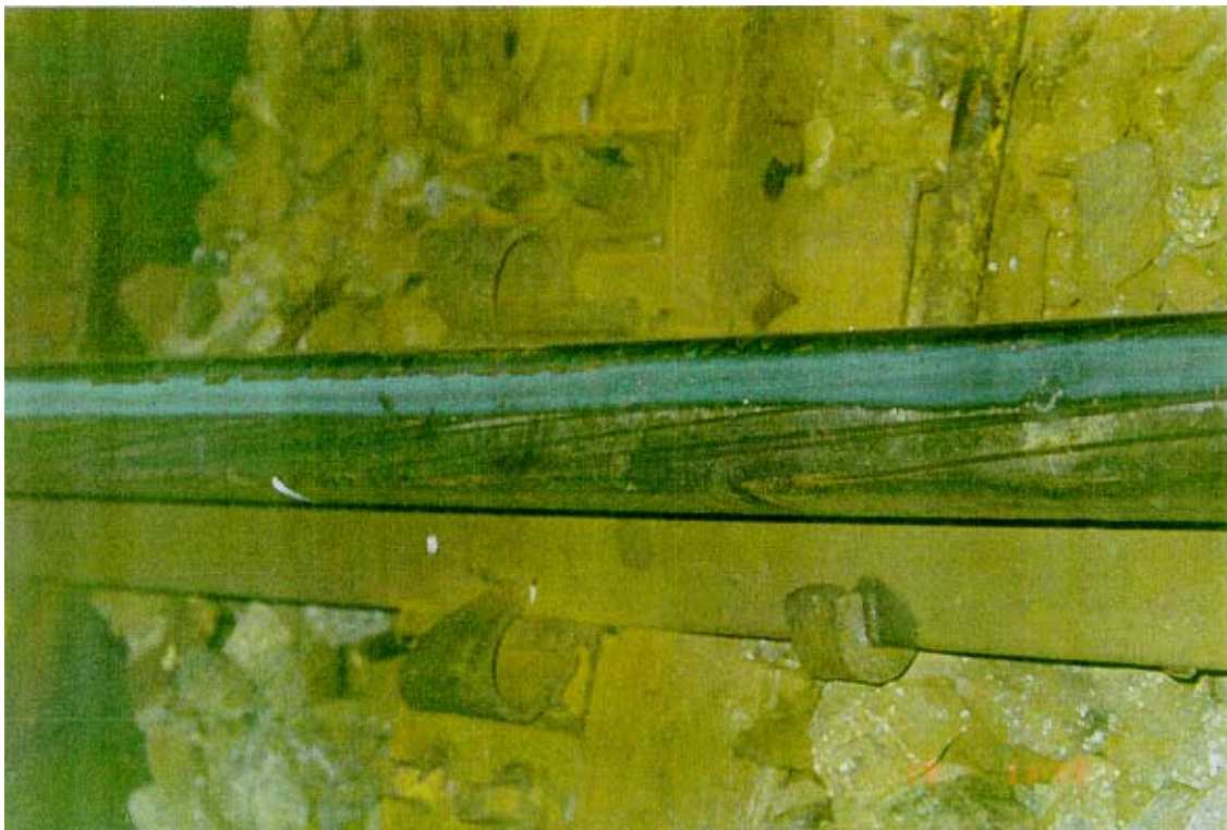
Kuva 5. Ensimmäiset suistumisjäljet. Pyöränlaippojen tekemiä jälkiä kiskon yläpinnassa 2 metrin matkalla. Juna tuli oikealta vasemmalle.
