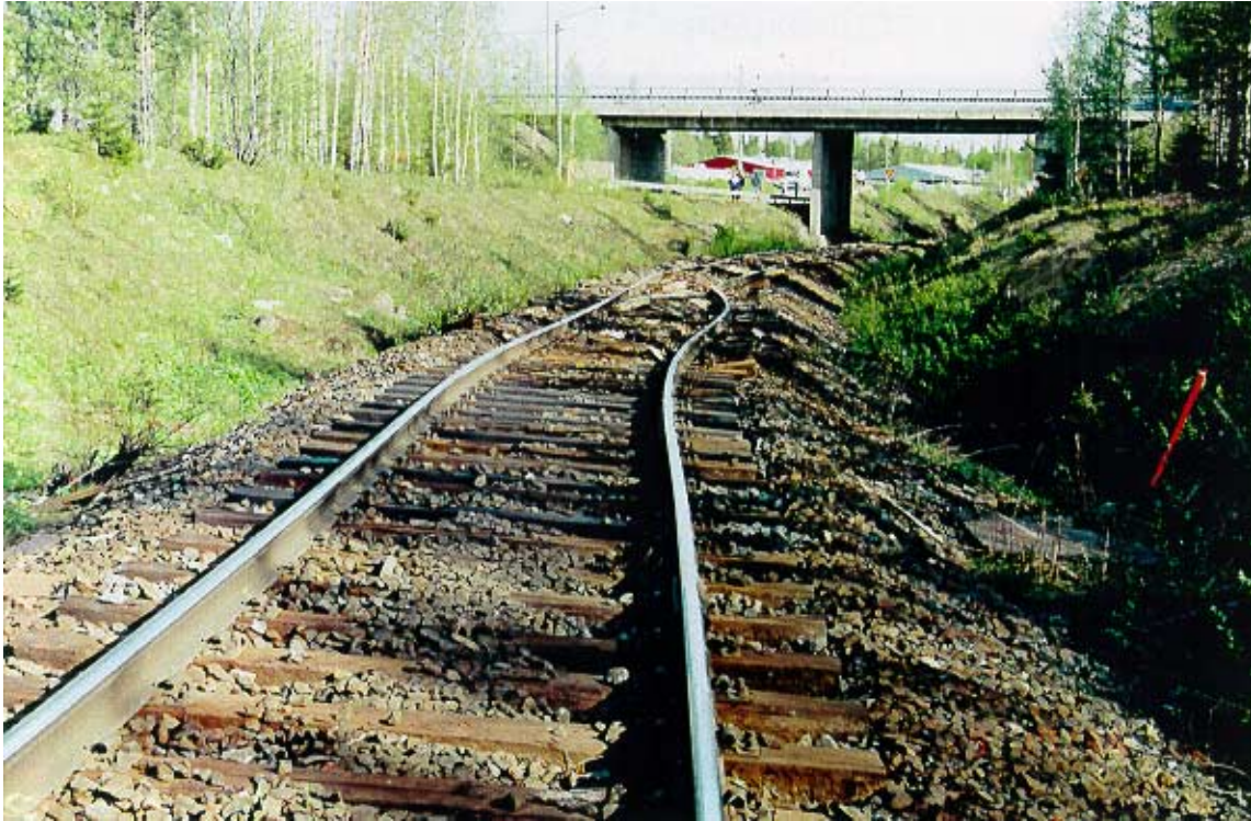
Kuva 3. Raide oli siirtynyt vasemmalle ennen suistumiskohtaa.
