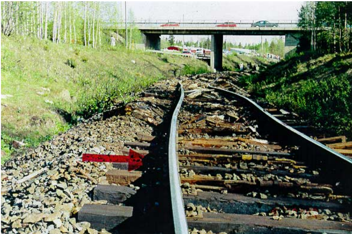
Kuva 4. Rikkoutunutta rataa junan tulosuunnasta katsottuna. Ensimmäiset suistumisjäljet ovat jälkimmäisen kiskojen välissä olevan siteen kohdalla (punainen nuoli)
