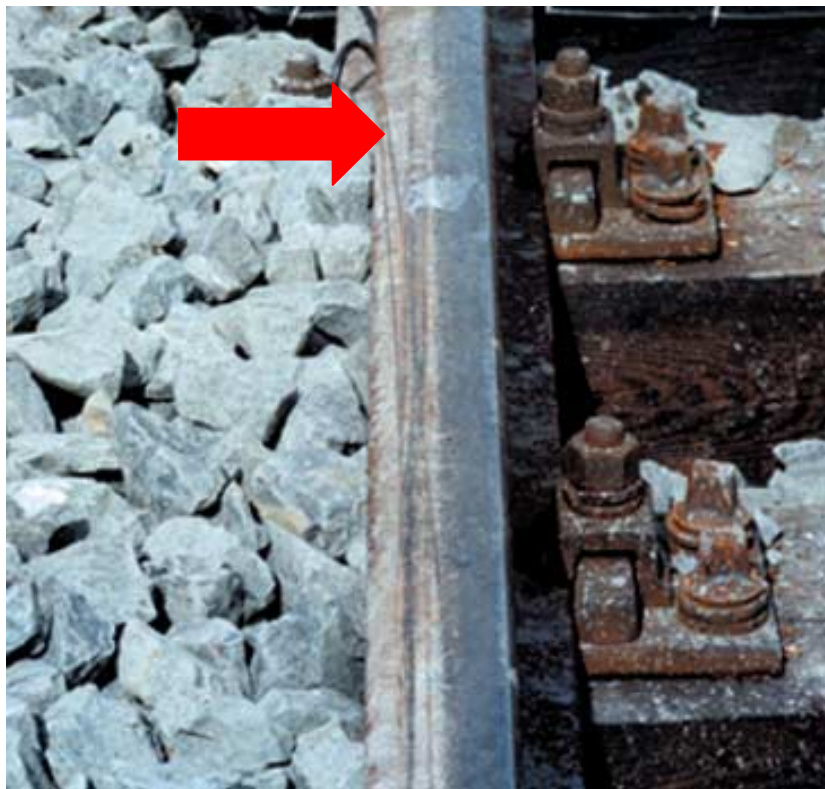
Kuva 3. Pyörän laippa on pudonnut kiskolta 20 metrin päässä kielen kärjestä.
