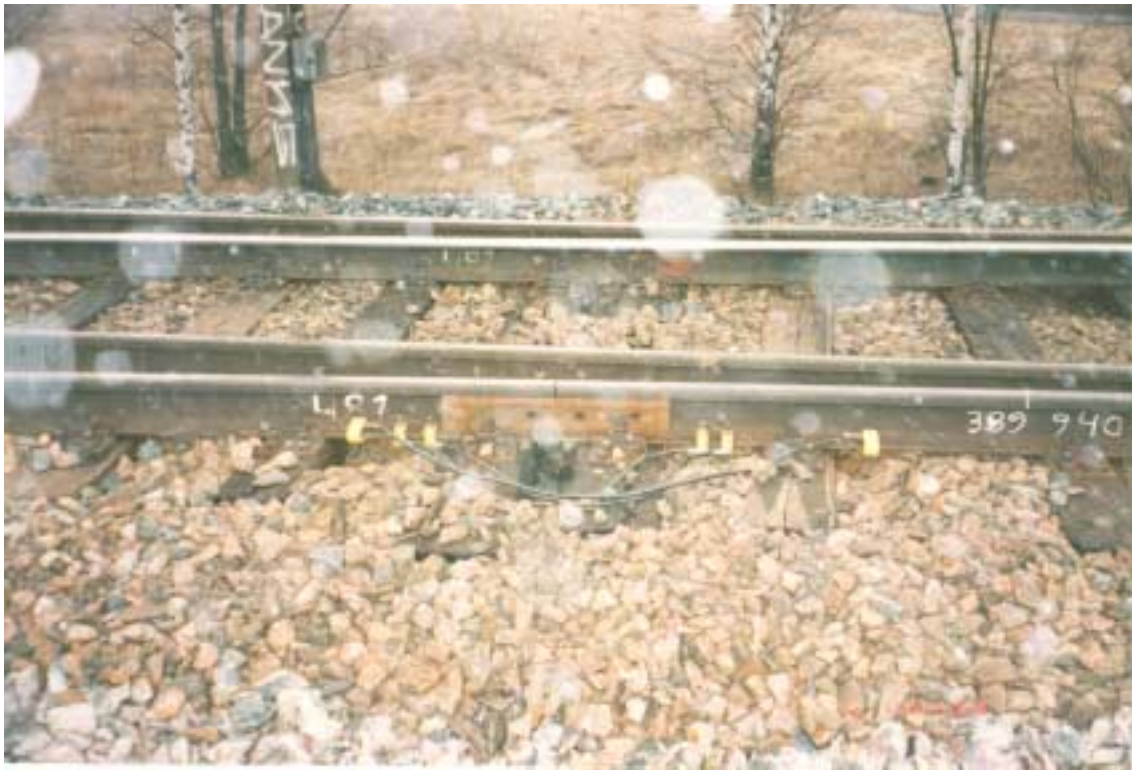
Kuva 8. Vaihteen tukikiskon katkaisukohta. Yksi kaapeleista oli kiinnitettynä junan tullessa vaihteelle. Kiskojen päitä liittämässä olevat sidekiskot on lisätty vaaratilanteen jälkeen.
