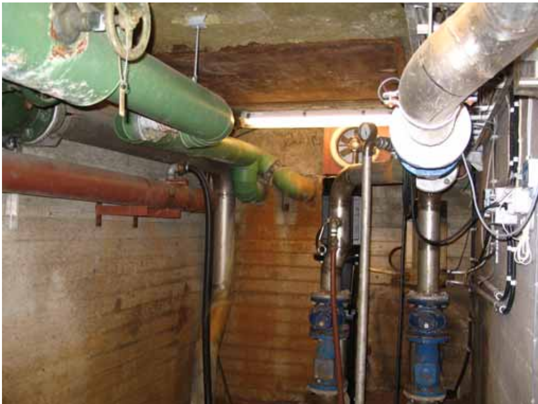
Kuva 8. Jätevedenpuhdistamon teknisen veden pumput.
