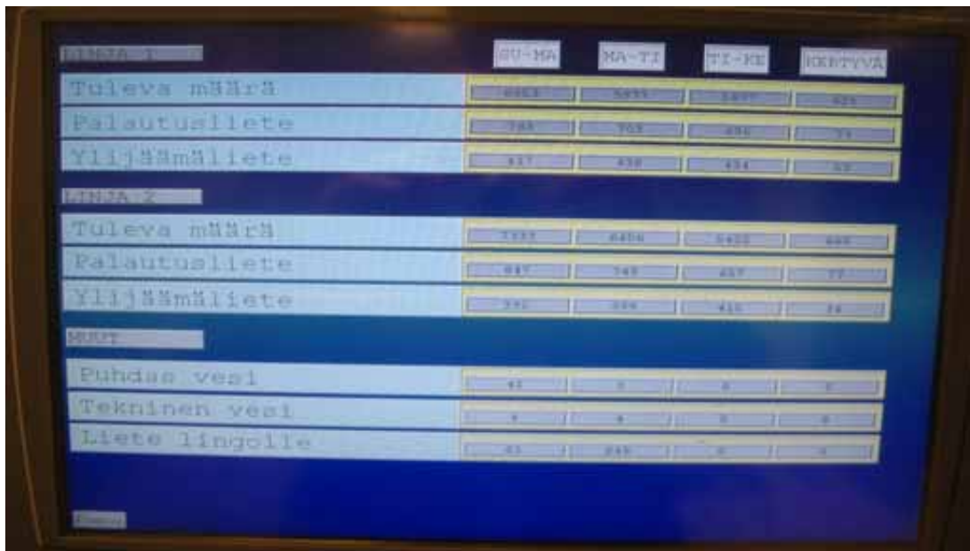
Kuva 4. Jätevedenpuhdistamon valvomossa sijaitseva käyttöpaneeli.
