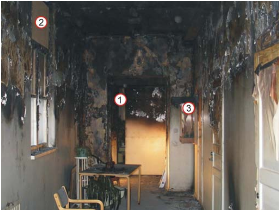
Kuva 12. Palon jälkeinen näkymä länsikäytävältä keskikäytävän suuntaan. Lämpötila tilan yläosassa on ollut palon aikana korkea ja alaosassa selvästi alhaisempi. 1. Itäsiiven muusta rakennuksesta erottava, 30 cm raolleen jäänyt liukupalo-ovi, 2. palossa rikkoutunut ikkuna ja 3. puhelinkaappi.
