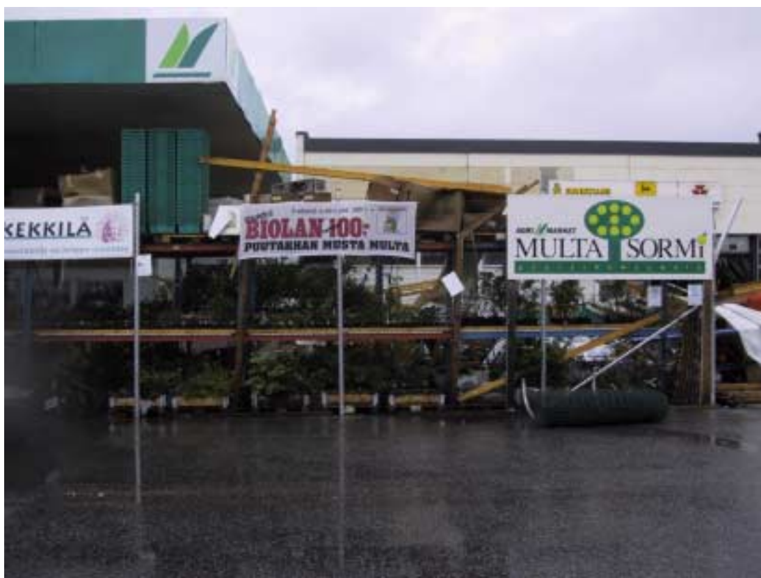
Kuva 3. Vasemmalla näkyy vihreä kiinteä katos. Tilapäinen katos oli verkkoaidan rajaaman alueen yläpuolella. Kuvassa etualalla näkyy kaksi hyllyihin kiinnitettyä kattoa kannattanutta pilaria, jotka ovat molemmat katkenneet. Oikeassa reunassa näkyy kaatuneena kolmas pilari. Katto kaatui oikealle, lähes kokonaan myyntitilan aidan ulkopuolelle. Kuvassa kaksi pilaria on katkennut juuri siitä kohdasta, josta ne olivat kiinni myymälän teräshyllyissä.
