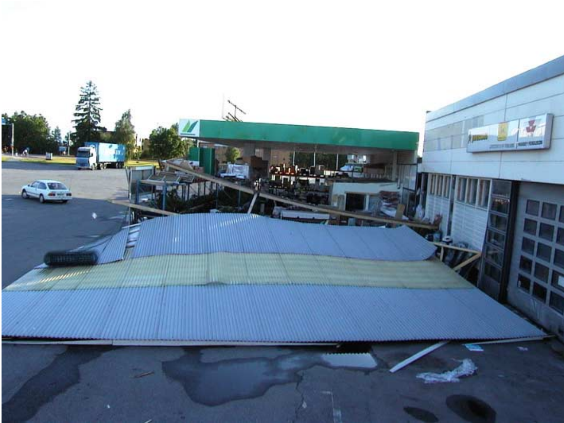
Kuva 4. Katos, jonka katemateriaalina oli profiilipellit ja valokatteet, putosi lähes kokonaan puutarhamyymälän ulkopuolelle, myymälän varaston oven eteen.
