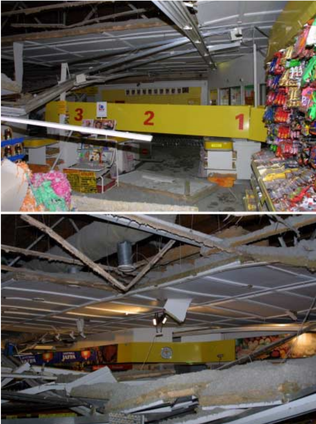
Kuva 4. Kuvia sisäkatosta ja sen vaurion aiheuttamista vahingoista.
