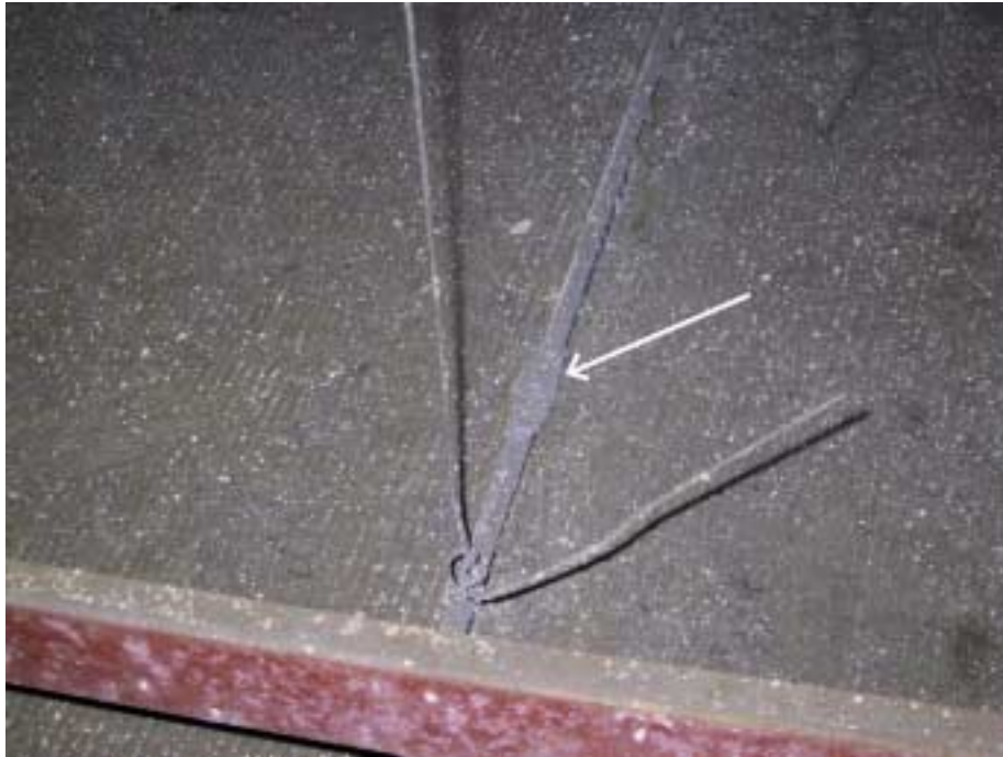
Kuva 9. Kuva vantaalaisen teollisuushallin Terminal-katosta. Kannatuslista on ripustettu, kuten Ruokavinkissäkin, rautalangoilla teräsristikoiden päällä oleviin lankkuihin. Nuolen osoittamassa kohdassa näkyy, miten ripustusosa asettuu kannatuslistan varaan. Ripustusosan alapäässä ovat valaisinlinjat.
