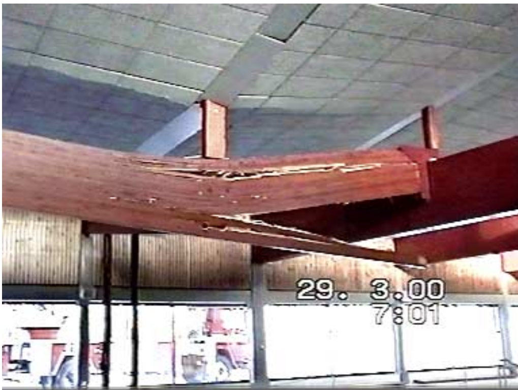
Kuva 6. Rikkoontunut liimapuupalkki juuri ennen kuin palokunta sai vajoamisen pysähtymään. Taustalla näkyy kaksi puunrunkoa, jotka palokunta kaatoi ja laittoi kattorakenteiden tueksi.
