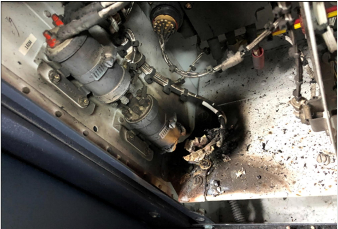
Kuva 4. Potkurin jäänpoistojärjestelmän palanut rele, kuva otettu ennen vian korjausta. (Kuva: Norra)
