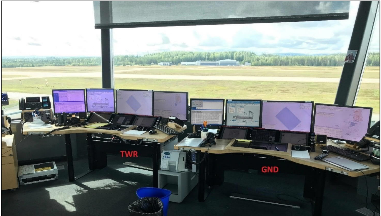
Kuva 5. Jyväskylän lähilennonjohdon työpisteet: TWR-työpiste vasemmalla ja GND-työpiste oikealla. (Kuva: Air Navigation Services Finland Oy)
